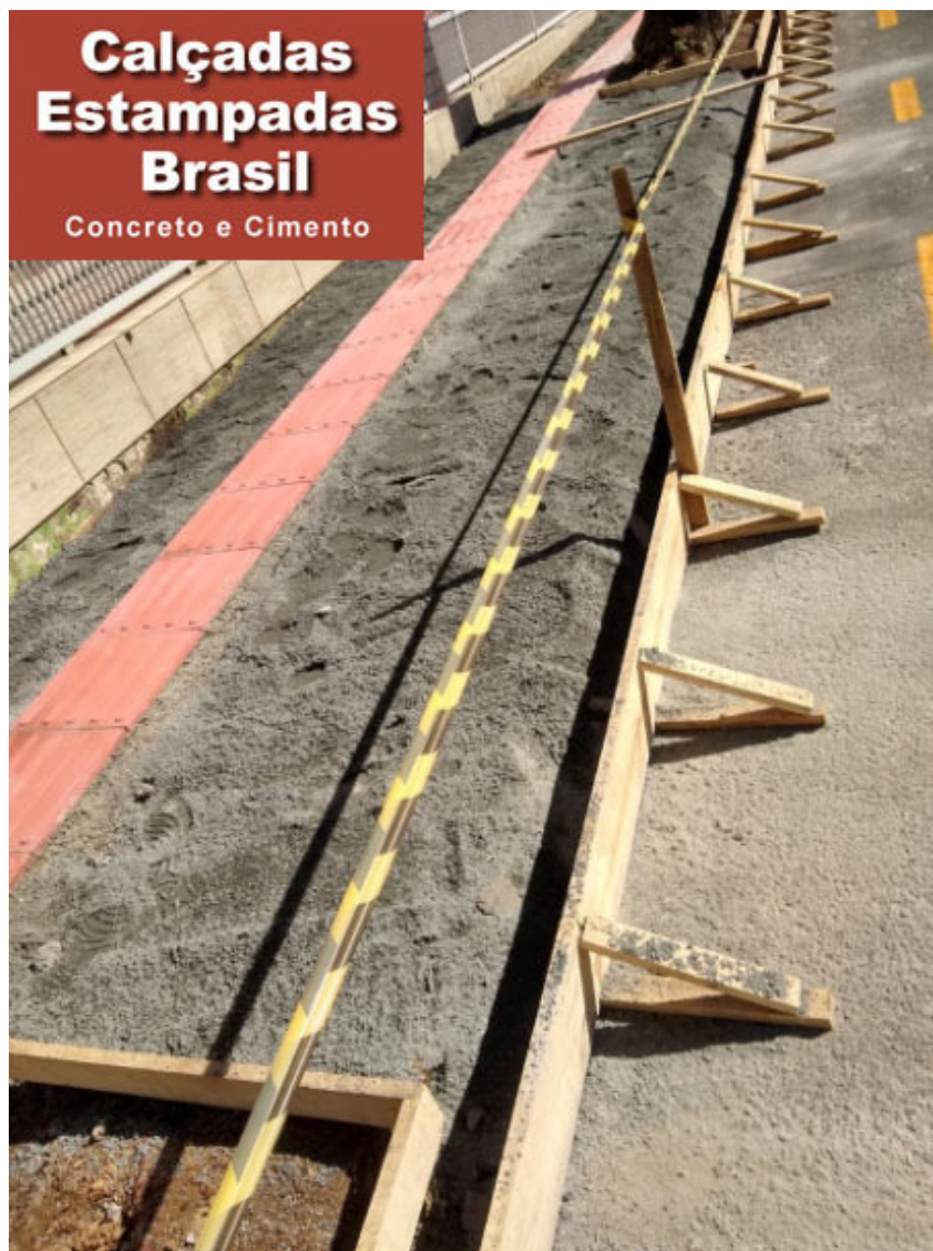
Figura 1: Antes de executar o piso de concreto estampado deverá ser assentado o piso tátil em concreto vermelho. Assim como também deverá ser preenchido para nivelamento.
