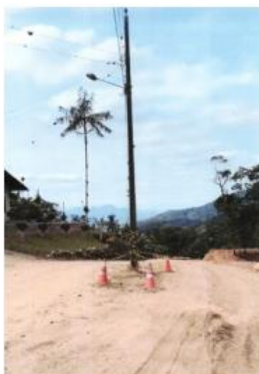
Figura 1 - Poste fora do alinhamento correto
