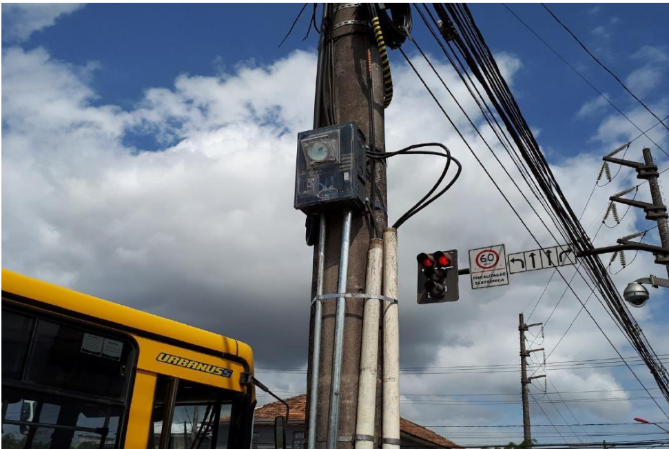
Figura 3 - Caixa de medição com lente – exemplo de instalação
