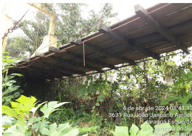
Figura 9 – Vigas travessas do tabuleiro / 01 tirante rompido
