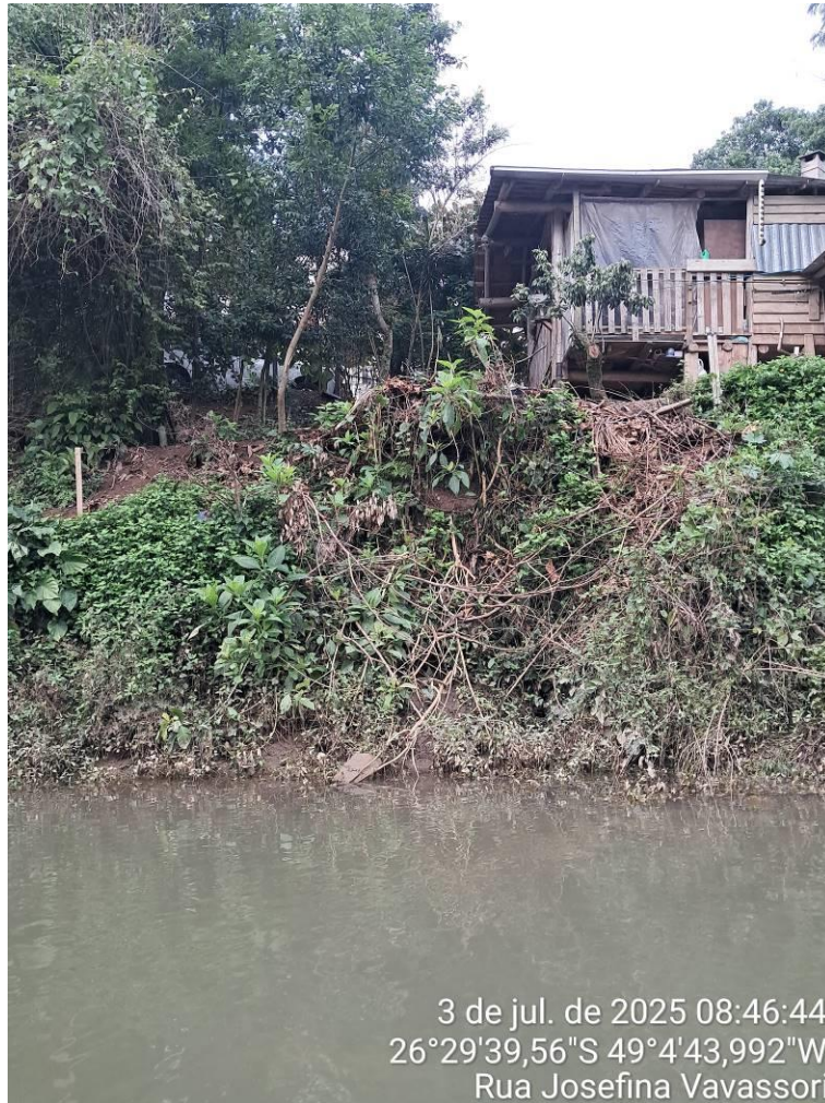
Foto 09 – Processo erosivo margem do rio (bairro Vila Nova)
