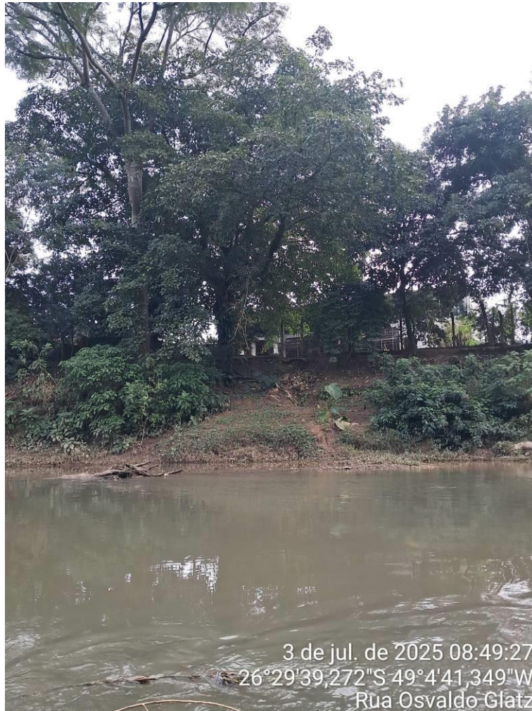
Foto 05 – Processo erosivo margem do rio (proximidade área lazer prédios – bairro Vila Nova)
