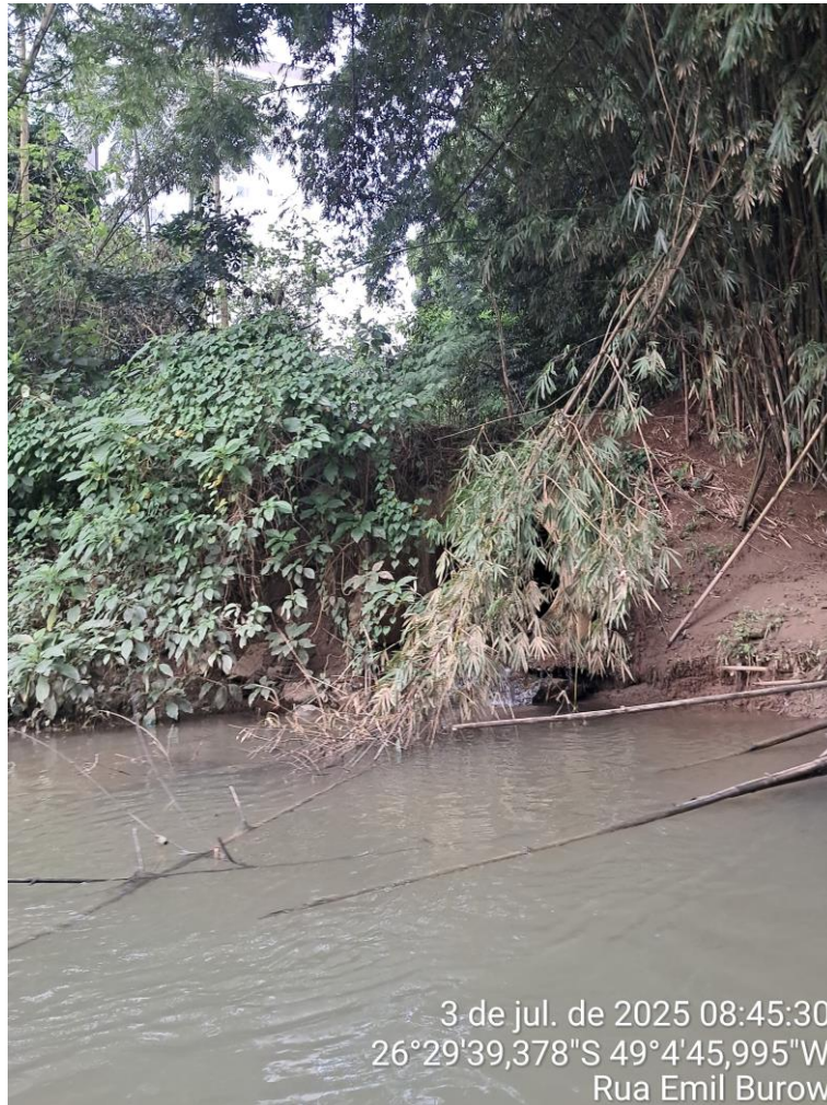
Foto 03 – Processo erosivo margem do rio (bairro Centro)
