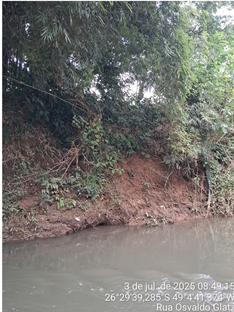
Foto 06 – Processo erosivo margem do rio (proximidade área lazer prédios – bairro Vila Nova)
