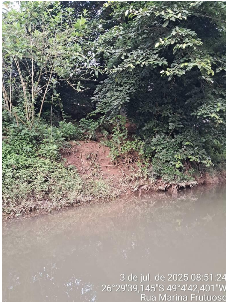
Foto 02 – Processo erosivo margem do rio (vegetação alta cobrindo parcialmente – bairro Centro)
