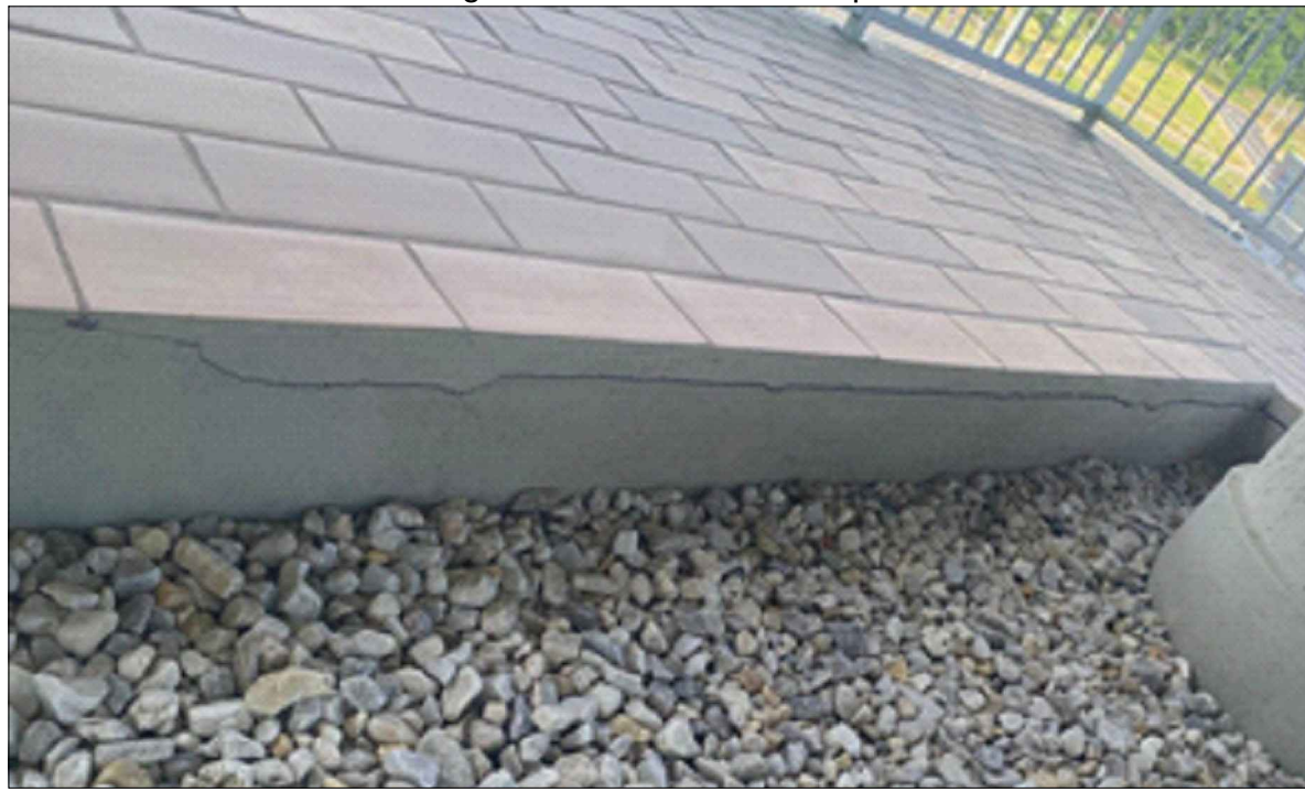
Imagem 05 - Microfissura no piso
