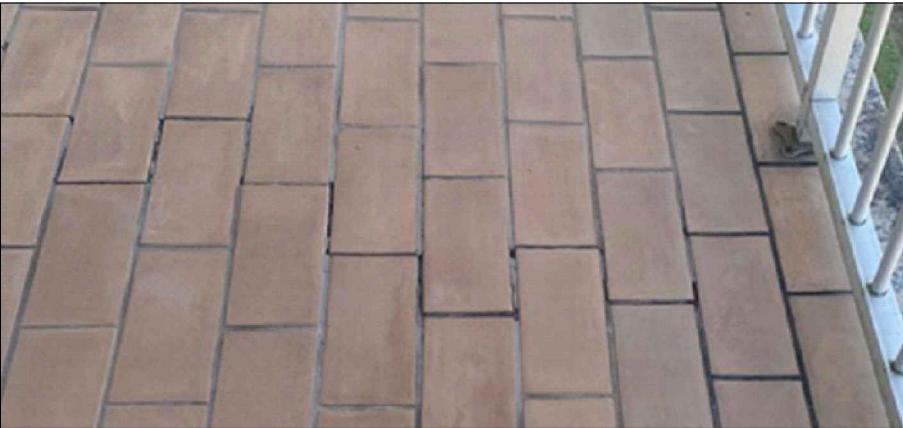
Imagem 07 - Peça cerâmica danificada na sacada
