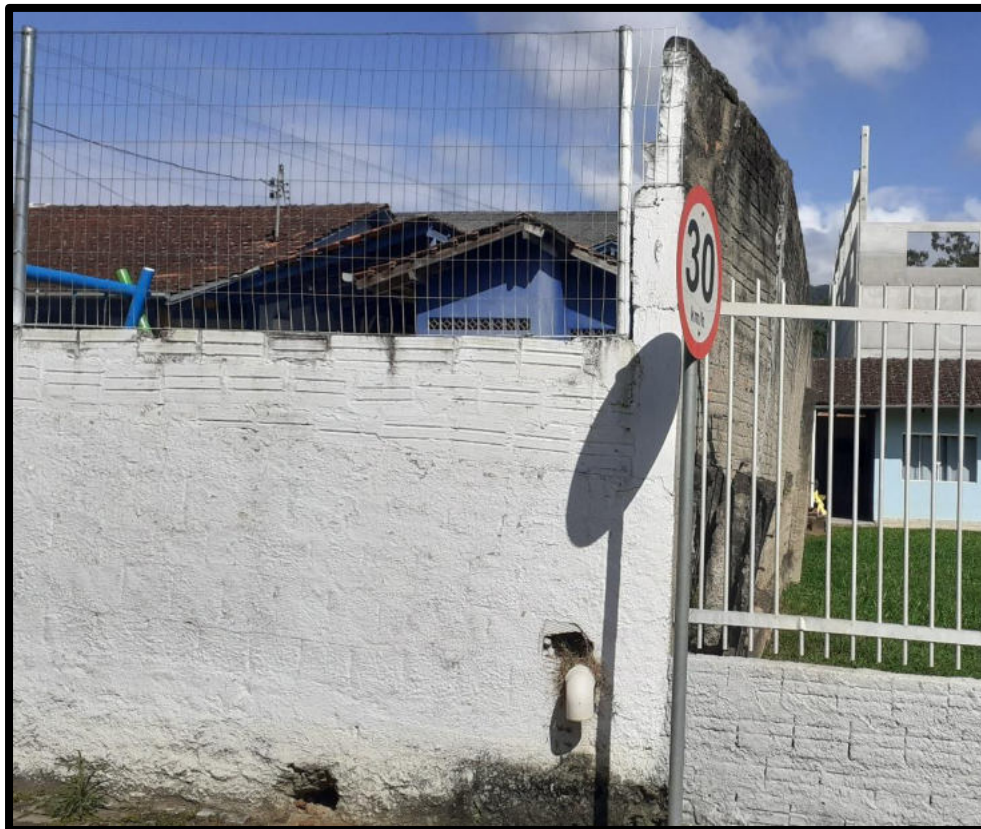
Muro em processo de tombamento.
