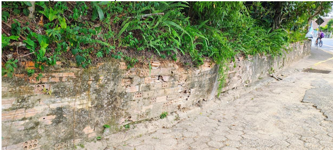
Figura 02 – Condições do muro existente na data de 19/01/2026
