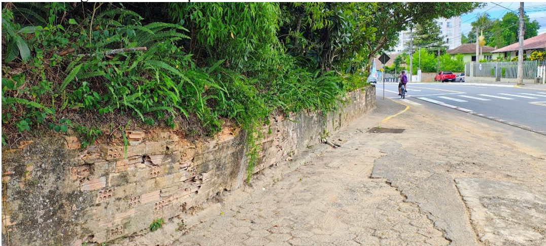
Figura 01 – Condições do muro existente na data de 19/01/2026
