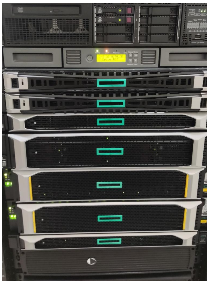
Figura 01 – Servidores – Storages, Servidor de backup e robô de fitas Atual
