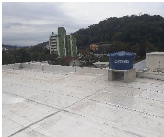
Reservatório superior para abastecimento água dos banheiros do terceiro pavimento
