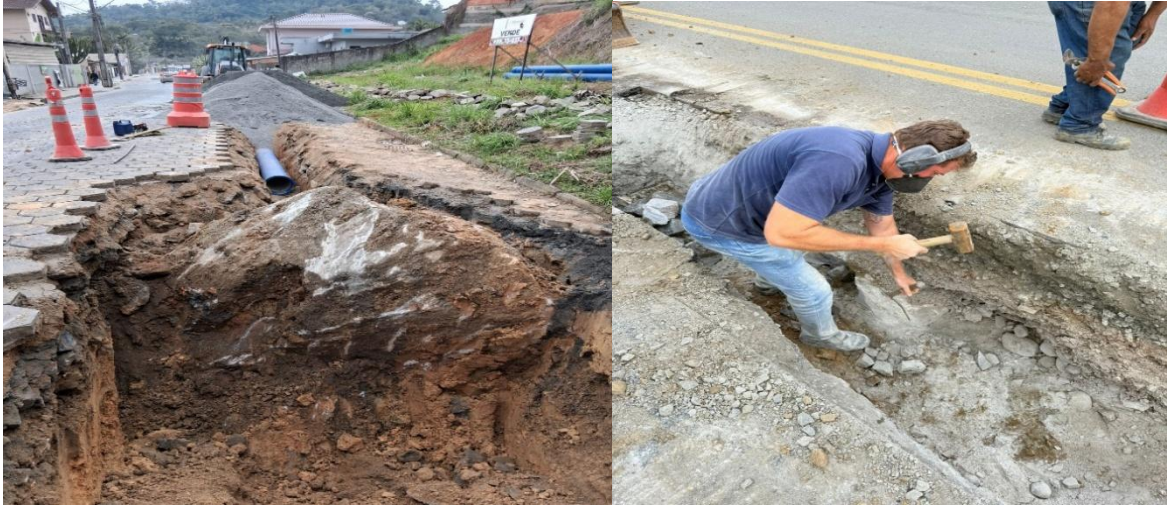
Figura 1 – Interferência da tubulação em vala e dificuldade de desmonte de rocha pela equipe do SAMAE.
