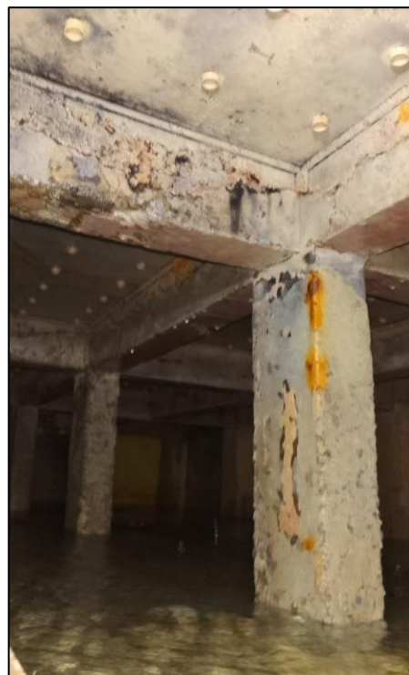
Figura 3- Fissuras aparentes e patologias graves nas vigas, pilares e lajes que sustentam o fundo falso- Fotos filtro 4
