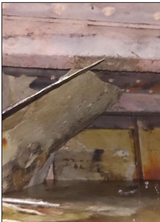
Figura 2- Deslocamento da fibra de impermeabilização estrutura de concreto comprometida – Fotos filtro 4
