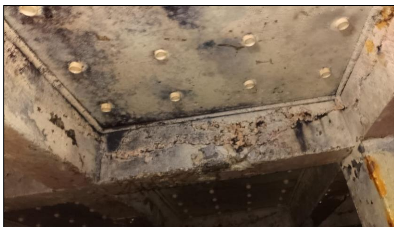
Figura 4 - Laje de fundo falso vista inferior com risco iminente de colapso - Fotos filtro 4
