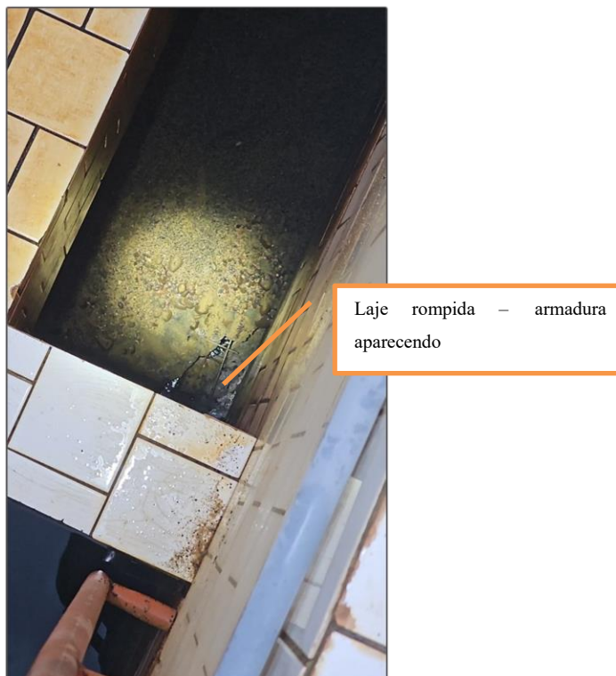
Figura 5 - Laje de fundo falso filtro 3– colapso dia 01/04/2026
