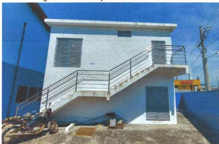
Figura 1 – Subestação abaixadora de tensão.
