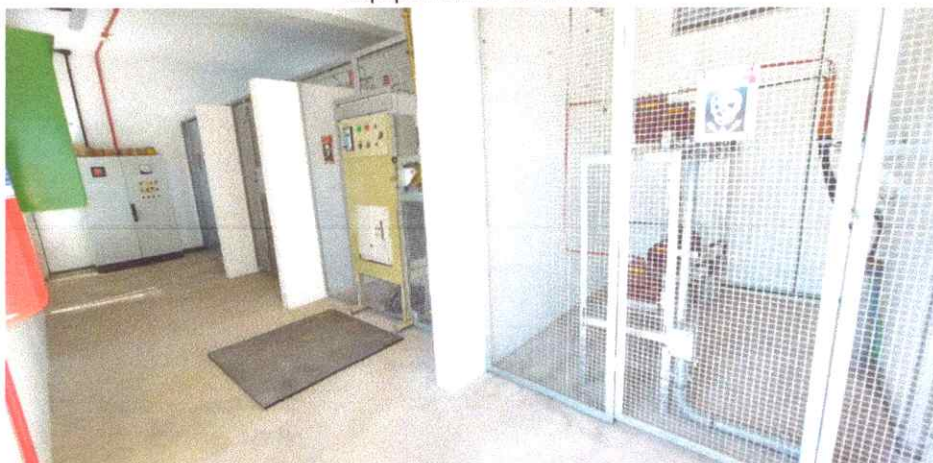
Figura 2 – Foto do interior de uma subestação de energia elétrica evidenciando o conjunto de equipamentos elétricos.
