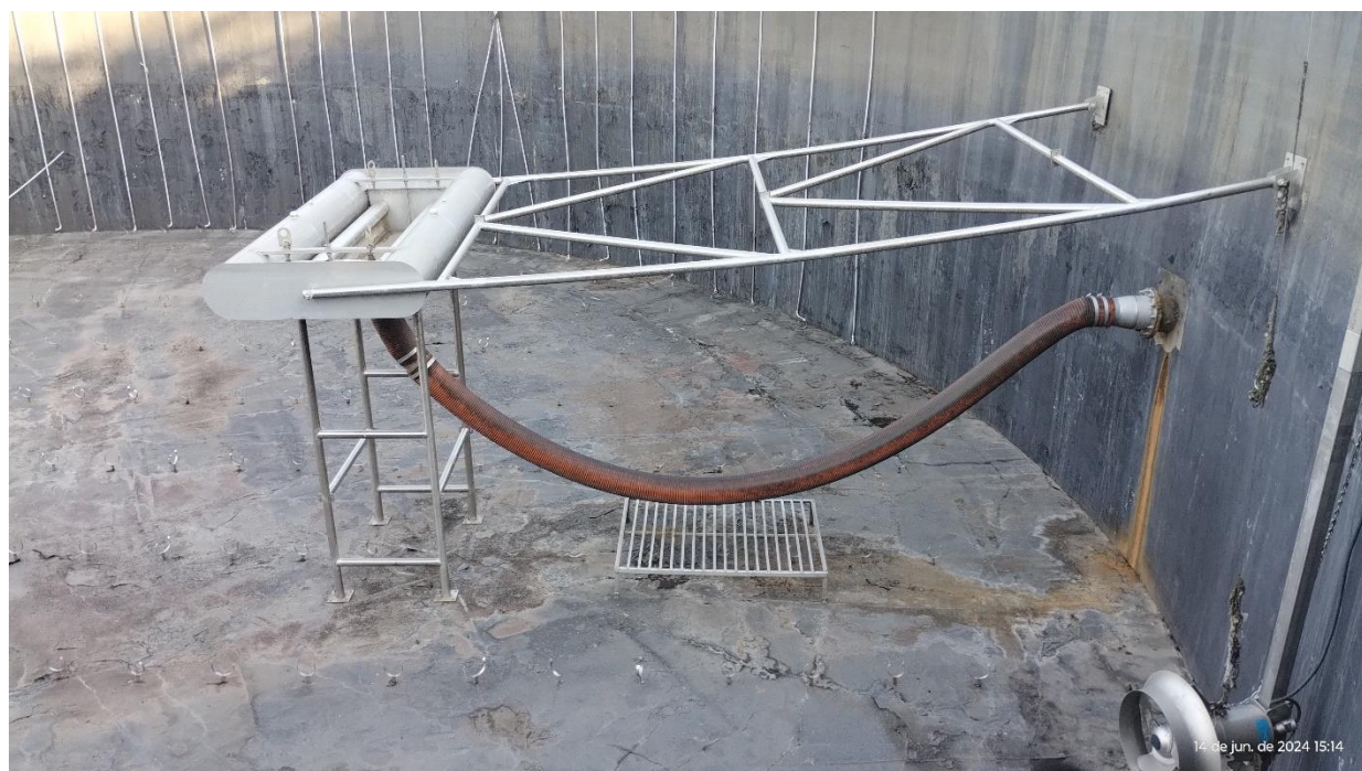
Imagem 13 – Vertedor flutuante atual instalado nos reatores.
