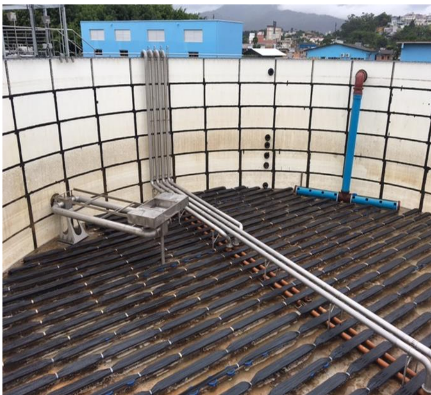
Imagem 16 – Vertedor com sistema de cabos e polias instalado na ETE Água Verde utilizado como referência para este projeto (Referência: Projeto executivo, fornecimento e instalação pela empresa Rotária do Brasil).
