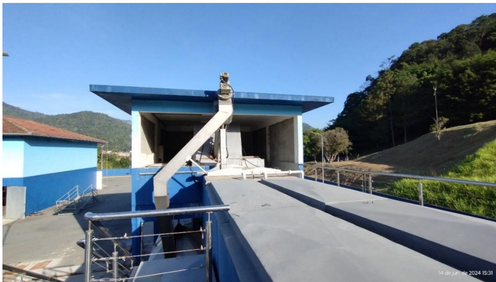
Imagem 04 – Sistema do canal de entrada da estação de tratamento.
