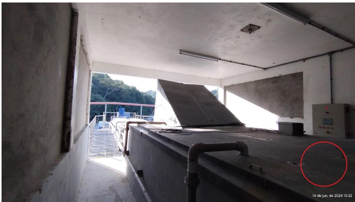
Imagem 06 – Local de instalação de sistema de sucção de H 2 S na tampa do canal de entrada.
