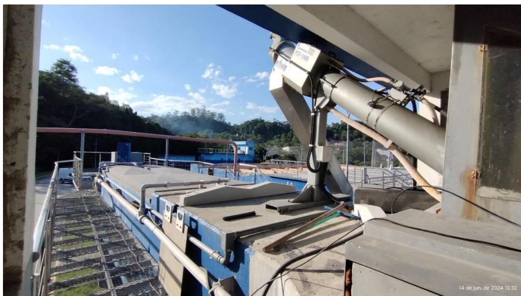
Imagem 05 – Sistema do canal de entrada da estação de tratamento.
