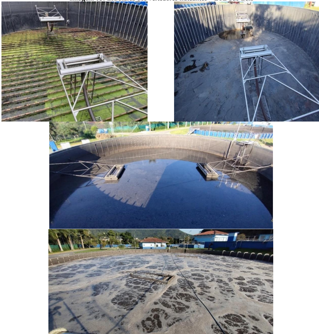
Imagem 05: Estruturas dos vertedores flutuantes – ETE São Luis
