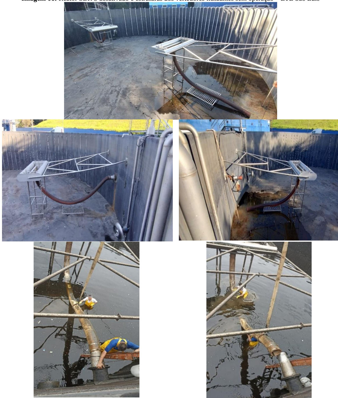
Imagem 06: Reator SBR 3 desativado e estruturas dos vertedores flutuantes sem operação – ETE São Luis
