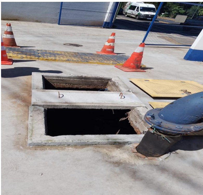
Poço principal de bombeamento
