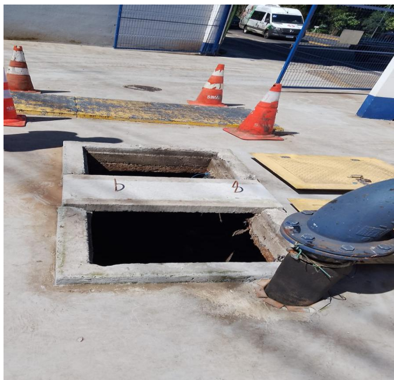
Poço principal de bombeamento
