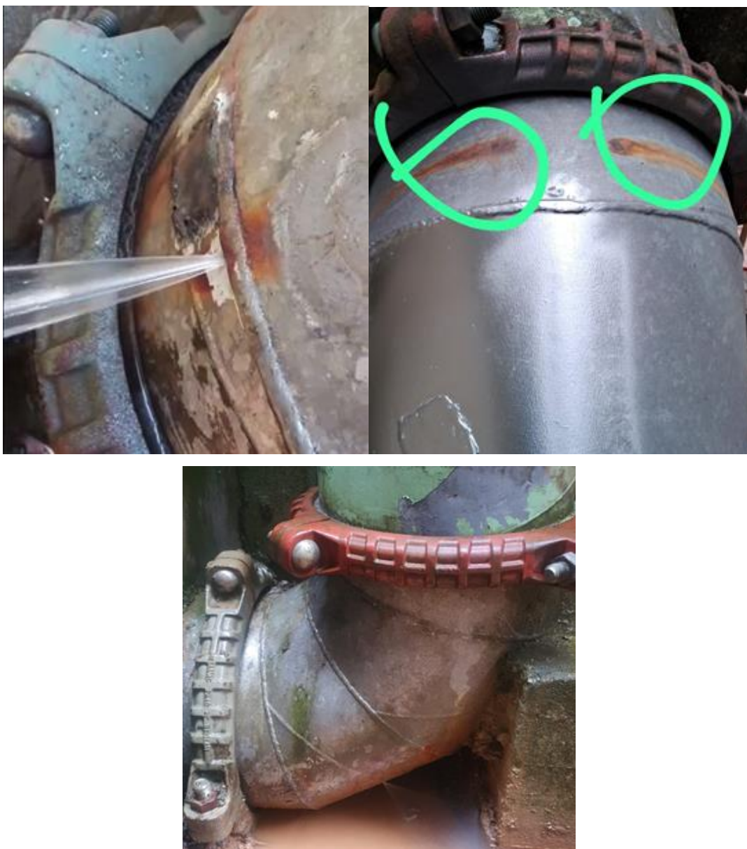
Imagens 01,02 e 03: Vazamentos e pontos comprometidos.
