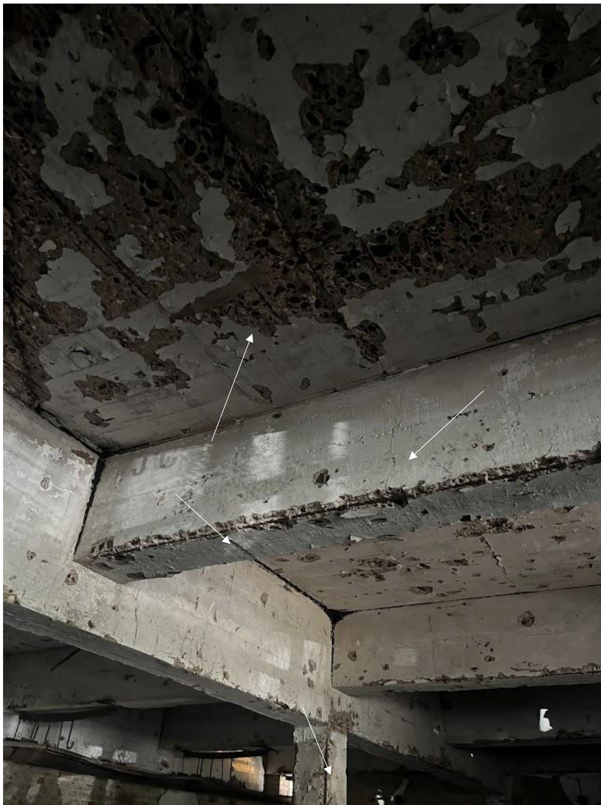
Deslocamentos, fissuras e exposição dos aços no 2º pavimento.
