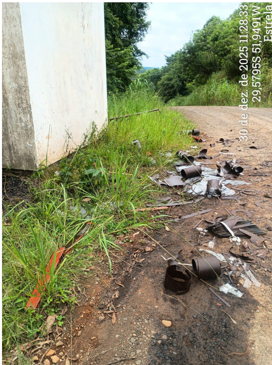
Foto 4 – Partes internas do transformador abandonadas pelo chão.
