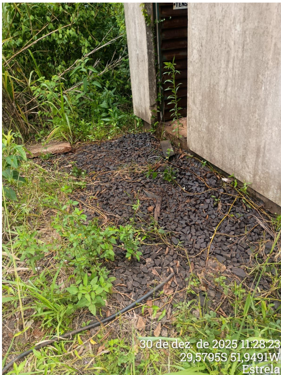
Foto 6 – Grande dano ambiental com espalhamento do óleo do transformador.
