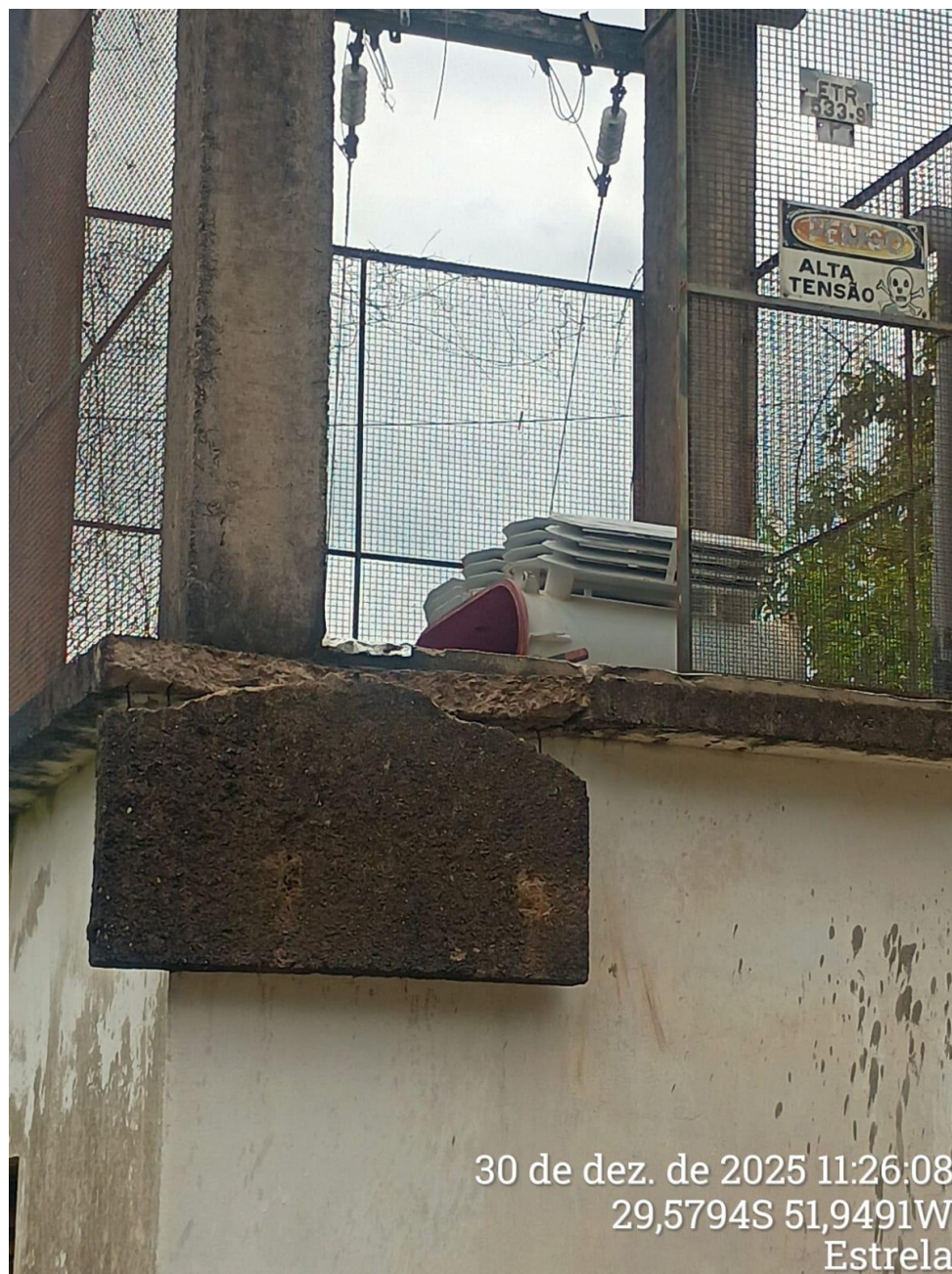
Foto 2 – Detalhe da laje quebrada.
