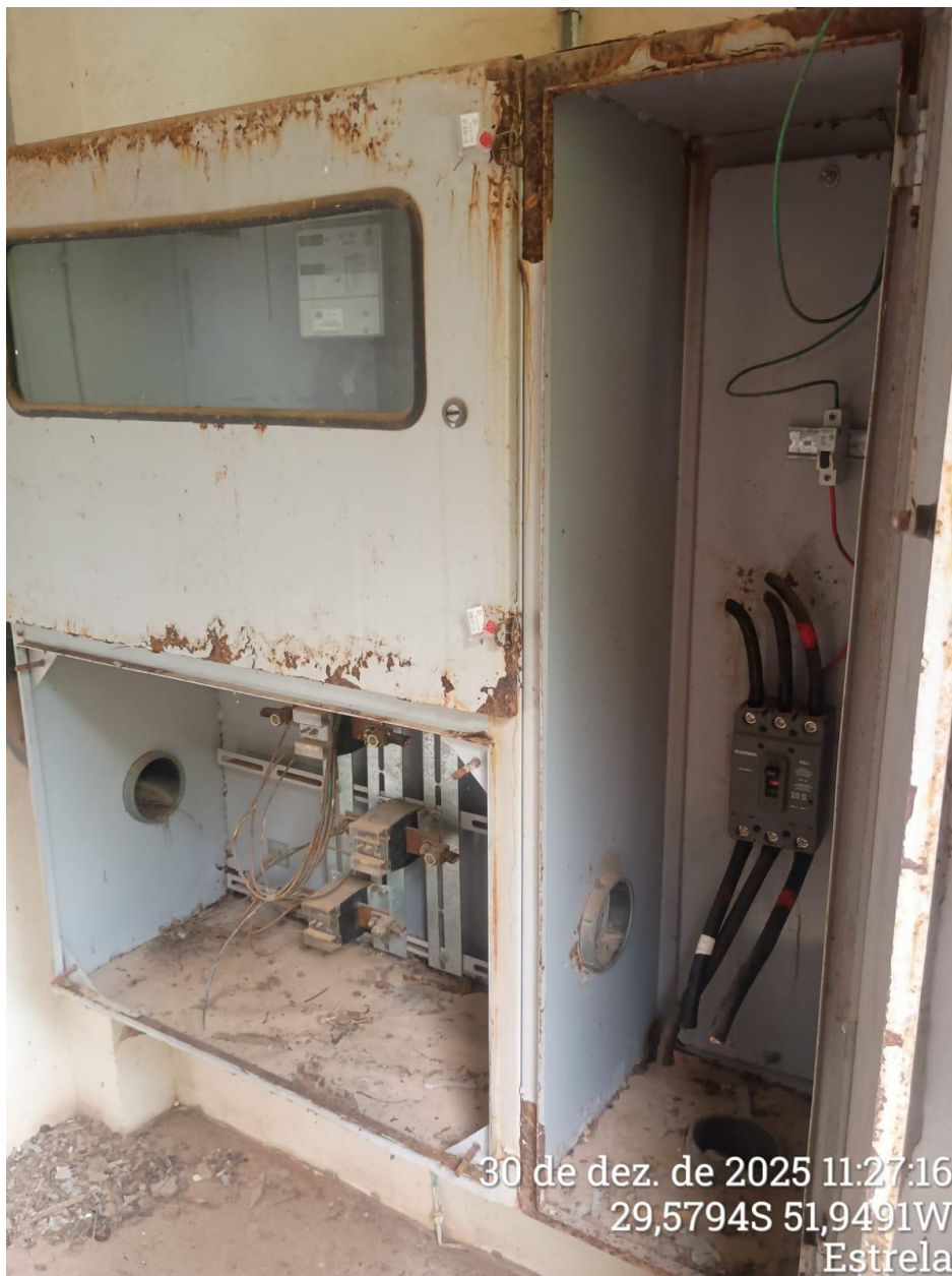
Foto 5 – Painele de medição arrombado, com a supressão dos cabos de cobre.
