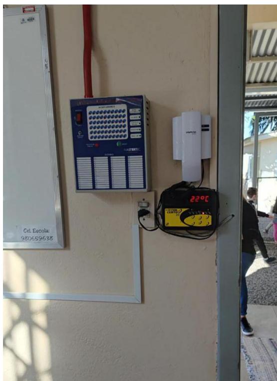
Figura 16: Central de alarme instalada na EMEF São Judas Tadeu.
