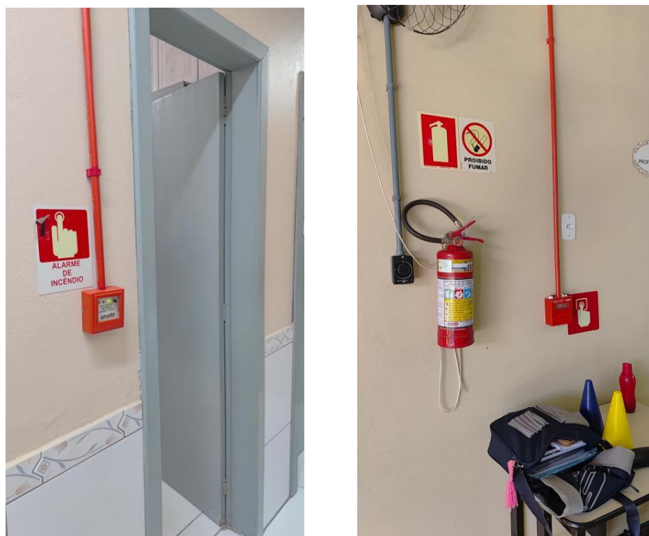
Figura 15: Sistemas de alarme instalados na EMEI Arco-Íris e EMEF São Judas Tadeu.
