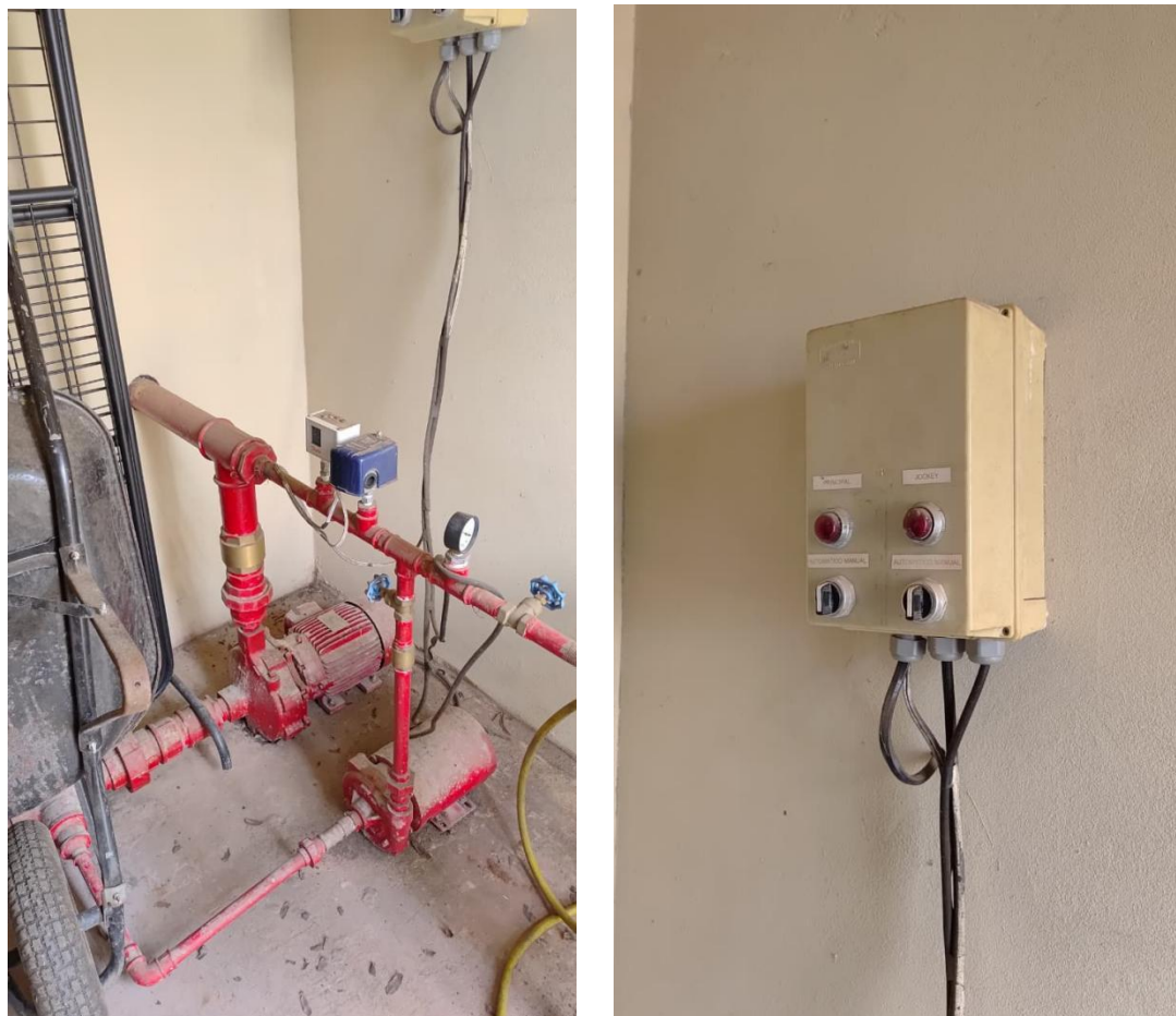
Figura 07: Instalações existentes na casa de bombas da EMEF São Judas Tadeu.
