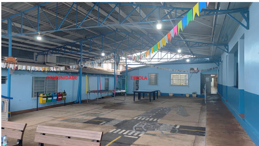
Figura 22: Telhado que avança sobre a comunidade.
