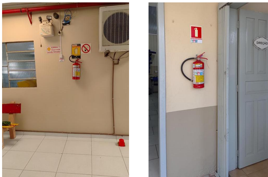
Figura 03: Exemplo de extintores existentes na EMEI Arco Íris e EMEF São Judas Tadeu.
