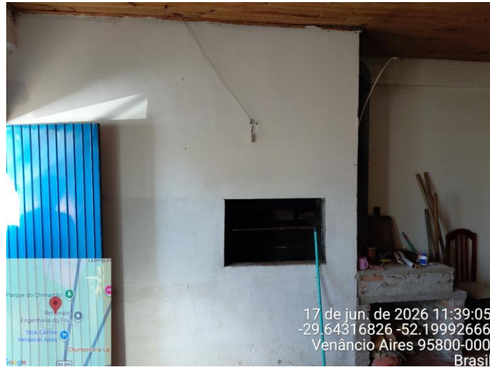
Foto 07: Churrasqueira do anexo, será demolida.
