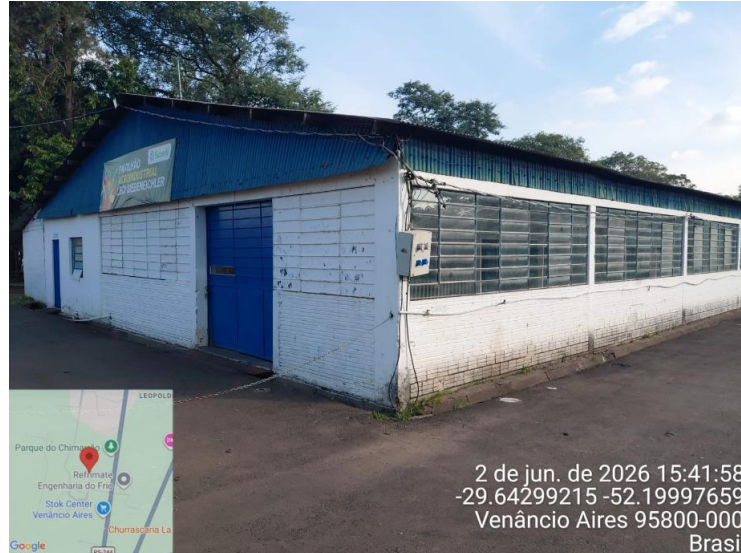
Foto 17: Frente e lateral direita, as janelas com os vidros pintados, serão retiradas e fechadas com alvenaria.
