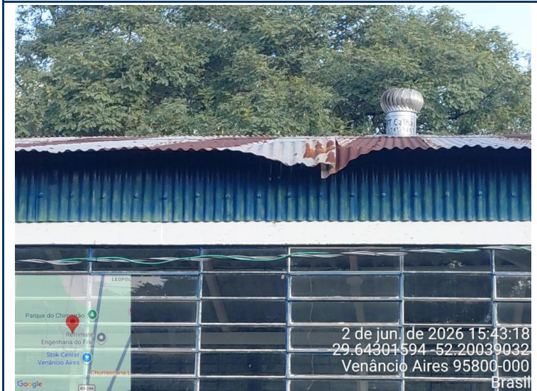
Foto 15: Avaria no telhado.
