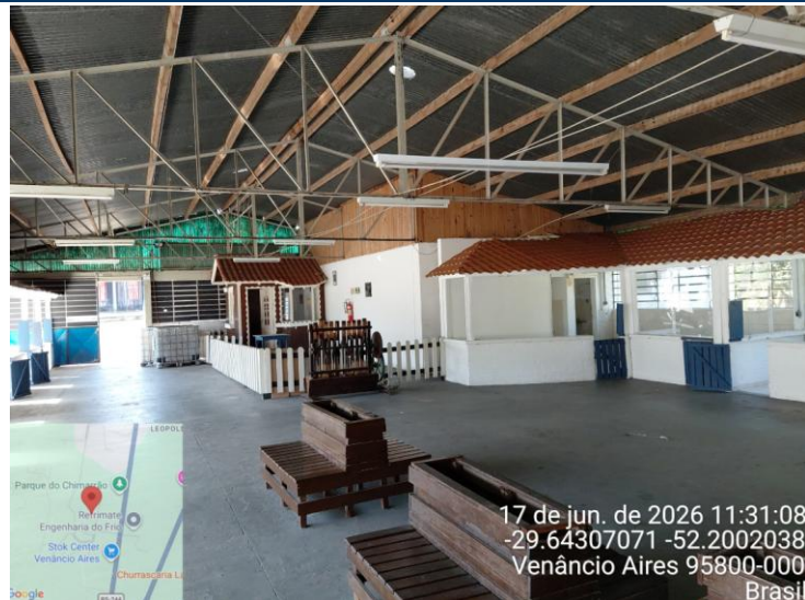
Foto 20: Terças que serão substituídas por metálicas e reposicionadas, as tesouras serão mantidas, lixadas e pintadas.
