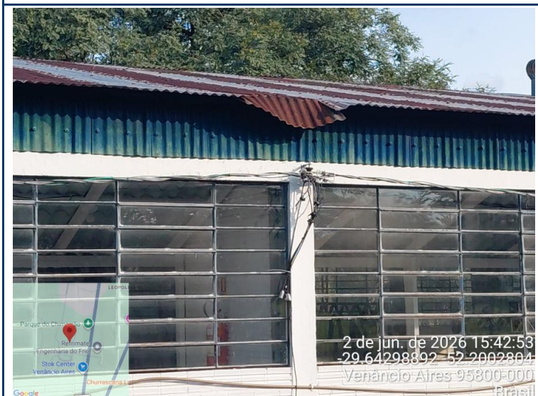
Foto 16: Avaria no telhado.
