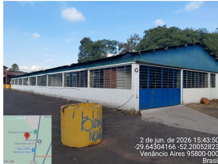
Foto 11: Lateral direita vista dos fundos, vedação lateral será substituída.
