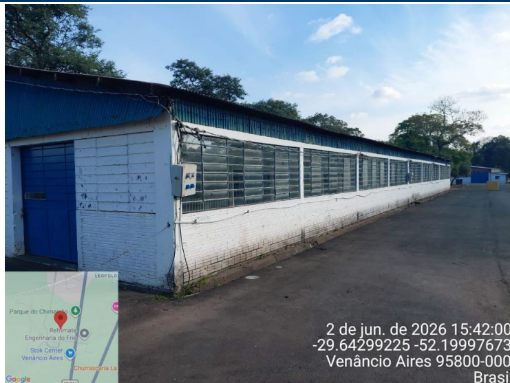
Foto 18: Lateral direita, vedação em telha será substituída.
