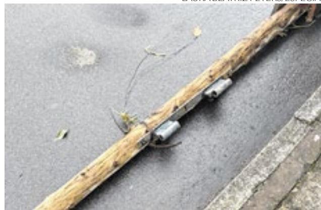
Poste caiu na Rua Canela, em Nova Petrópolis
