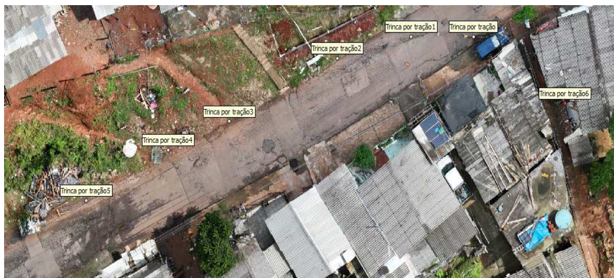
Imagem 06 - Trinca por tração
