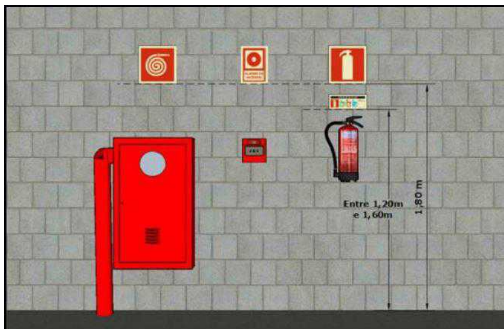
Figura 01 – Sinalização de Equipamentos.
