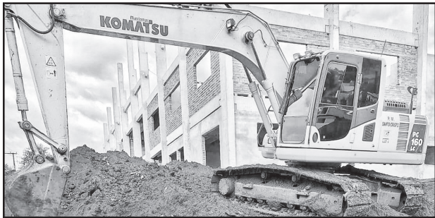
Aterramento no pátio do Ginásio de Esportes da Escola Paulo Freire
