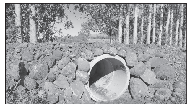
Substituição de ponte de madeira por tubulação de concreto na Linha Saturno.
