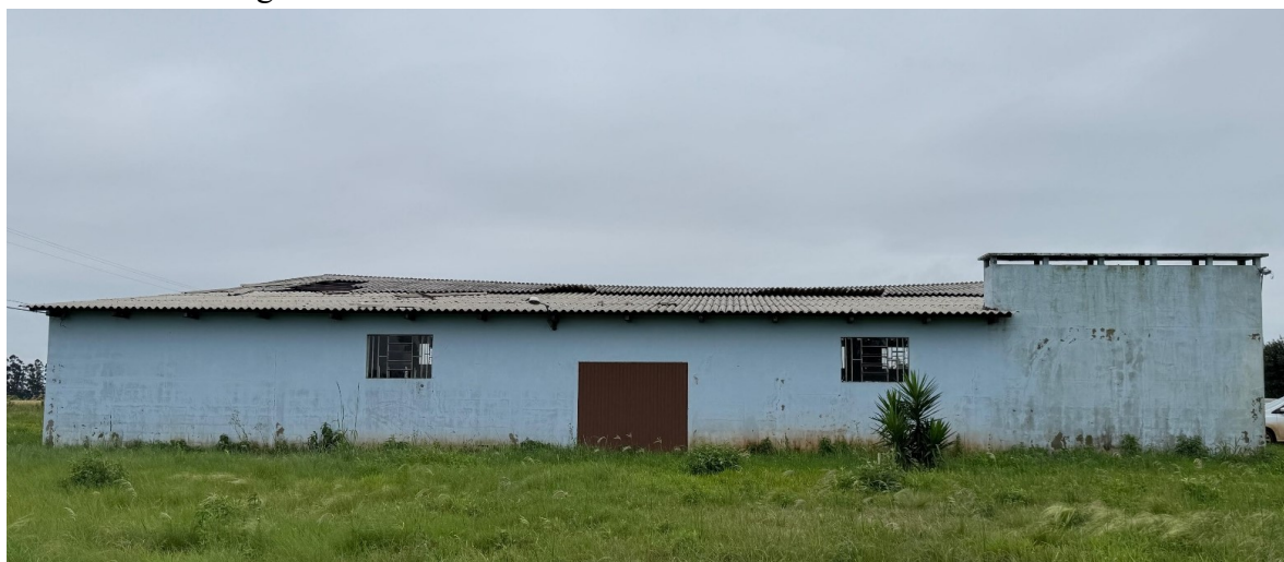
Figura 4: Cobertura com telhas em fibrocimento danificadas
