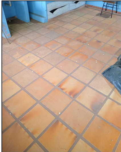
Figura 6 - Revestimento cerâmico a ser substituído na cozinha.
