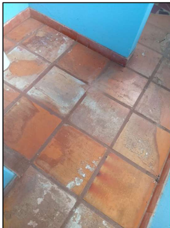
Figura 7 - Revestimento cerâmico a ser substituído nos sanitários.
