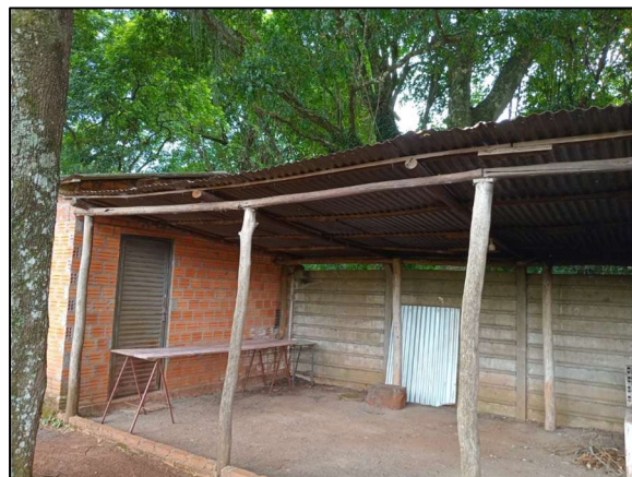
Figura 15 - Telhamento da área de churrasqueira a ser substituído e estruturado.
