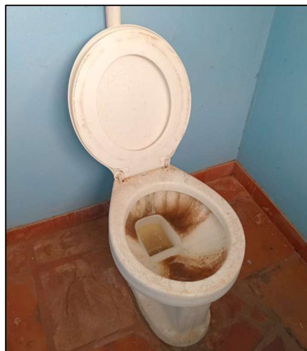
Figura 9 - Exemplar de bacia sanitária a ser substituída.
