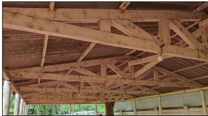
Figura 14 - Telhamento do refeitório a ser removido e estrutura de madeira a ser restaurada.
