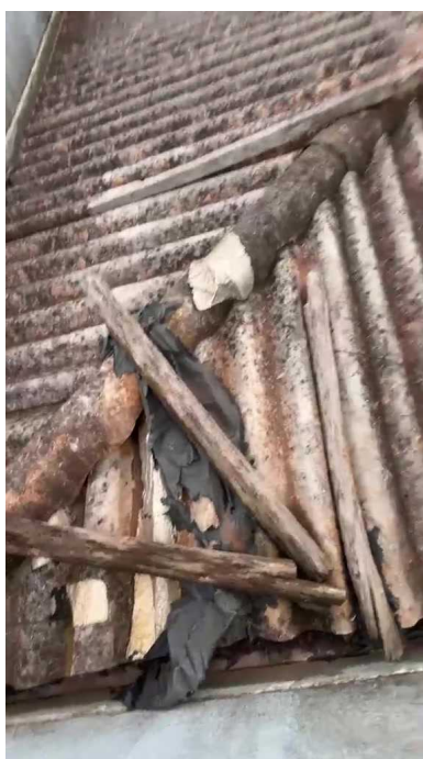
Foto 05 – Detalhe do canto: telhas rompidas, espigão danificado e peças de madeira soltas (quadro de vídeo).
