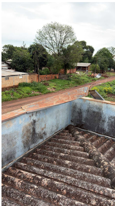
Foto 02 – Rufo arrancado e projetado para fora da platibanda.
