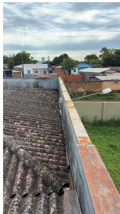
Foto 03 – Rufos com corrosão e peças deslocadas ao longo da platibanda.
