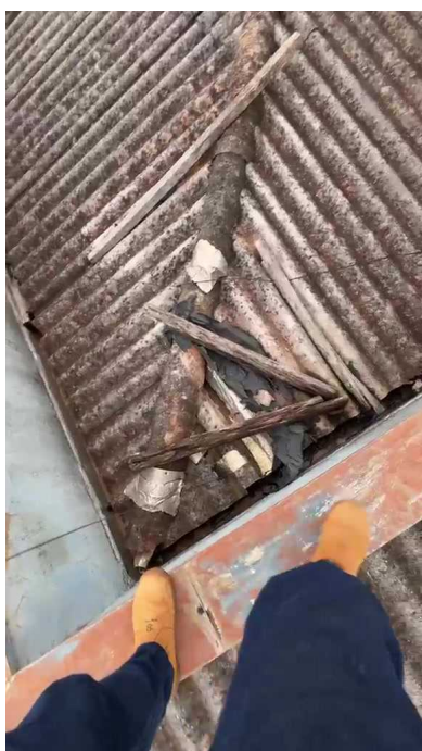
Foto 04 – Canto da cobertura com telhas e espigão quebrados e madeiramento solto (quadro de vídeo).
