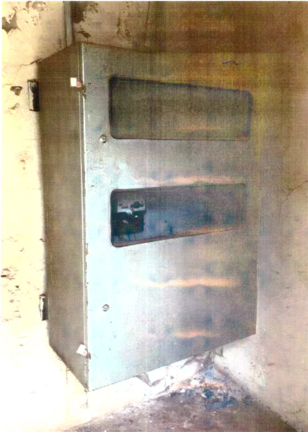
Figura 5. Painel de Medição de Energia
