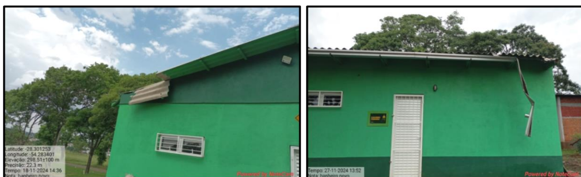
Imagem 10: Situação atual da telha e calha do banheiro que serão substituídas.
