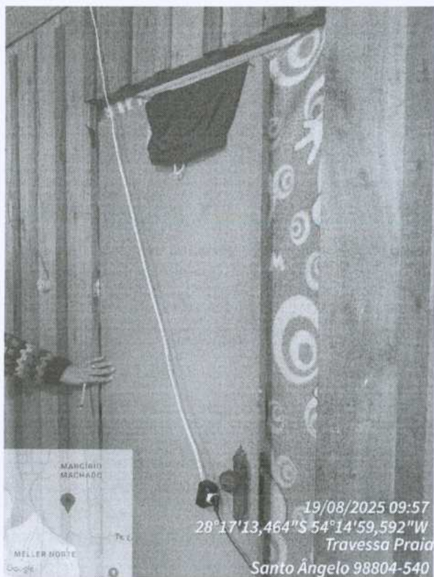
Foto 10: Detalhe porta menor que o vão.
