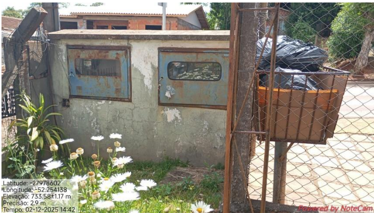
Figura 9 – Entrada de agua e luz, deverão ser substituídos por novos
