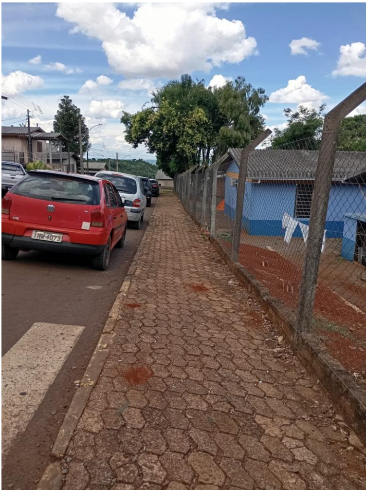
Figura 2 passeio existente na Rua N. Sra. que deverá ser refeito quando da troca do muro
