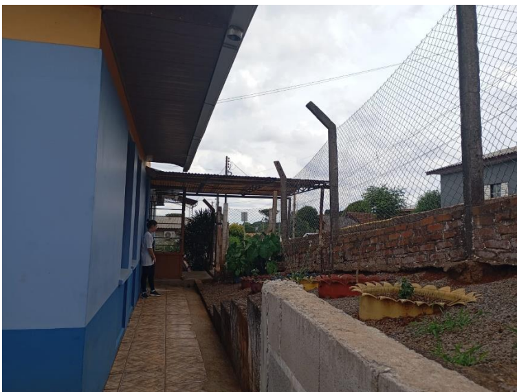
Figura 7 - calha sem tubo de queda, telhado entrada escola, piso em vários níveis
