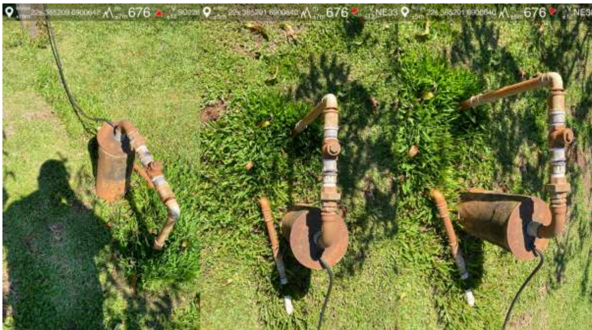
Figura 7 - Condições da cabeça do Poço 06 (Linha São Roque), evidenciando estrutura metálica com sinais de corrosão, ausência de laje de proteção sanitária, inexistência de cercamento e inadequação da vedação superior, sem dispositivos de controle operacional e sanitário.
