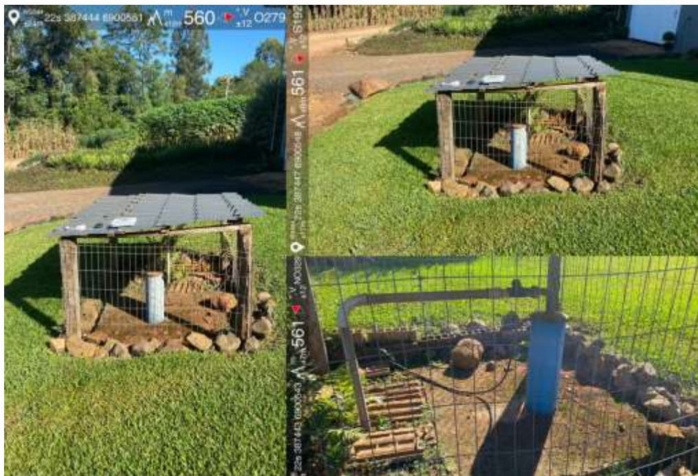
Figura 4 - Condições da cabeça do Poço 03 (Linha Santa Catarina), evidenciando presença de cercamento, cobertura superior e laje de proteção sanitária, com organização adequada da área imediata e ausência de dispositivos de controle operacional e sanitário.
