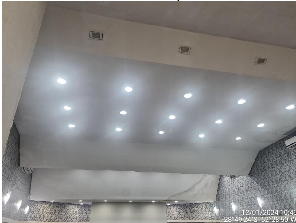
Imagem 06: Forro de Gesso com marcas de infiltração.
