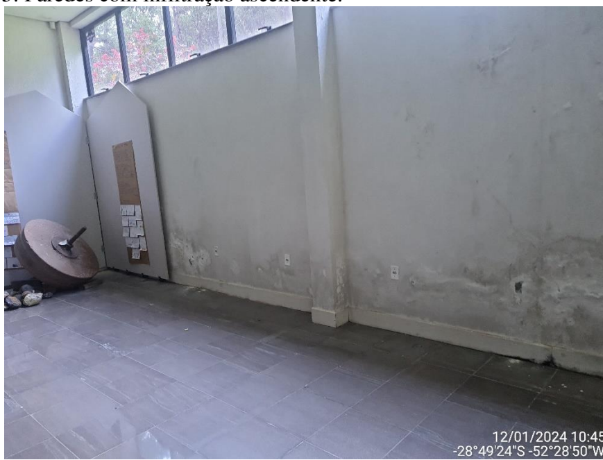
Imagem 05: Paredes com infiltração ascendente.
