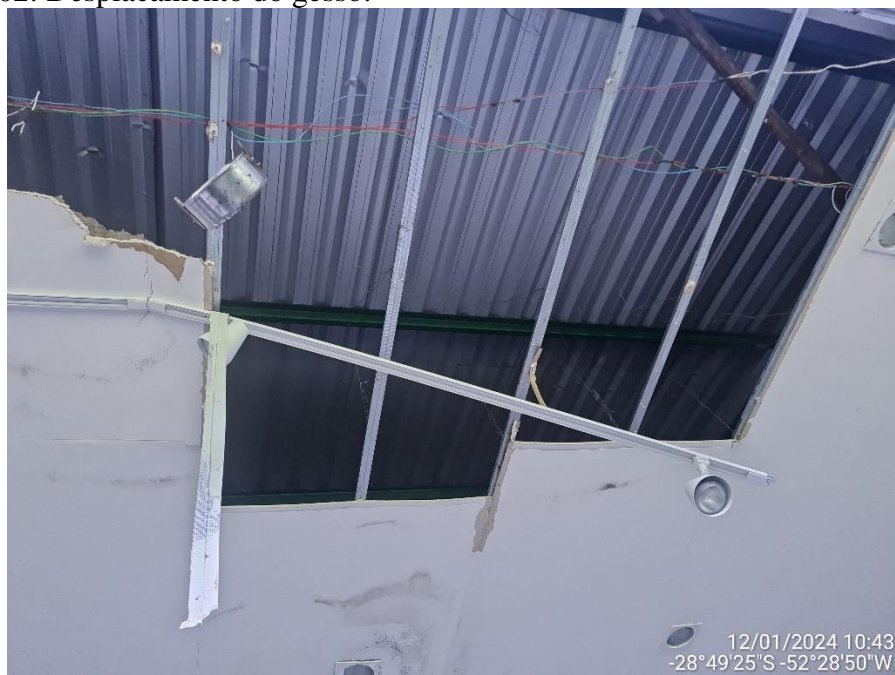
Imagem 02: Desplacamento do gesso.
