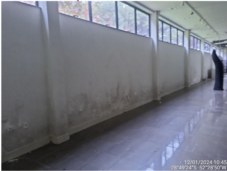
Imagem 04: Paredes com infiltração ascendente.
