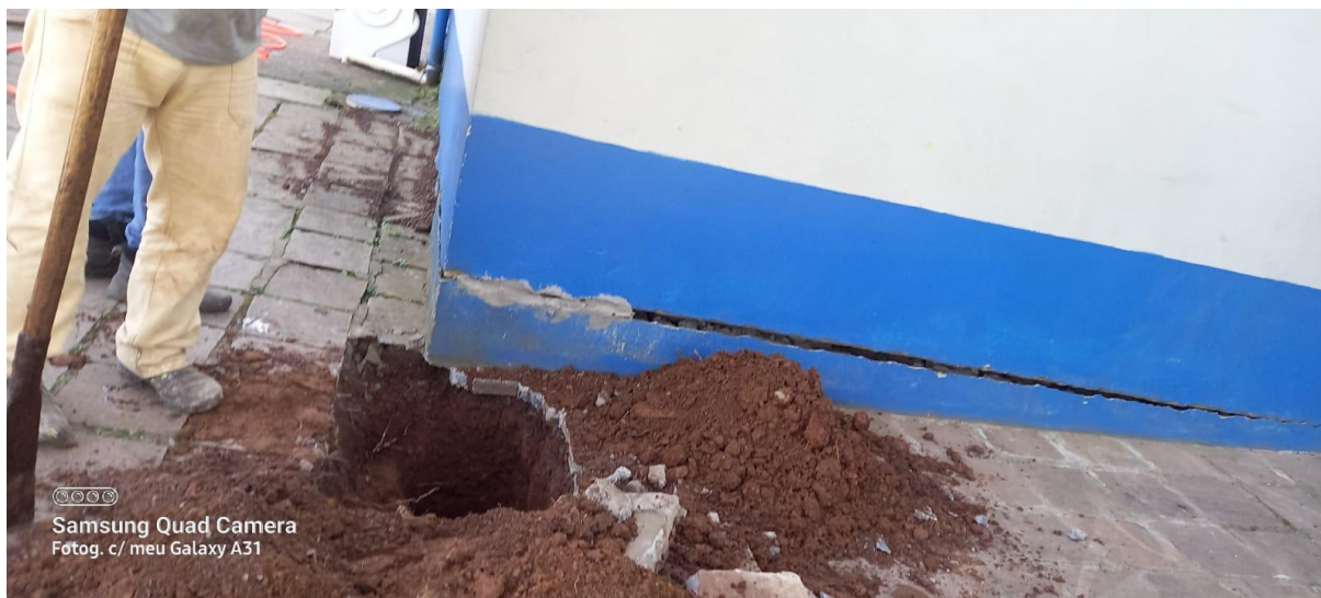
Canto da cozinha apresentando recalque.
