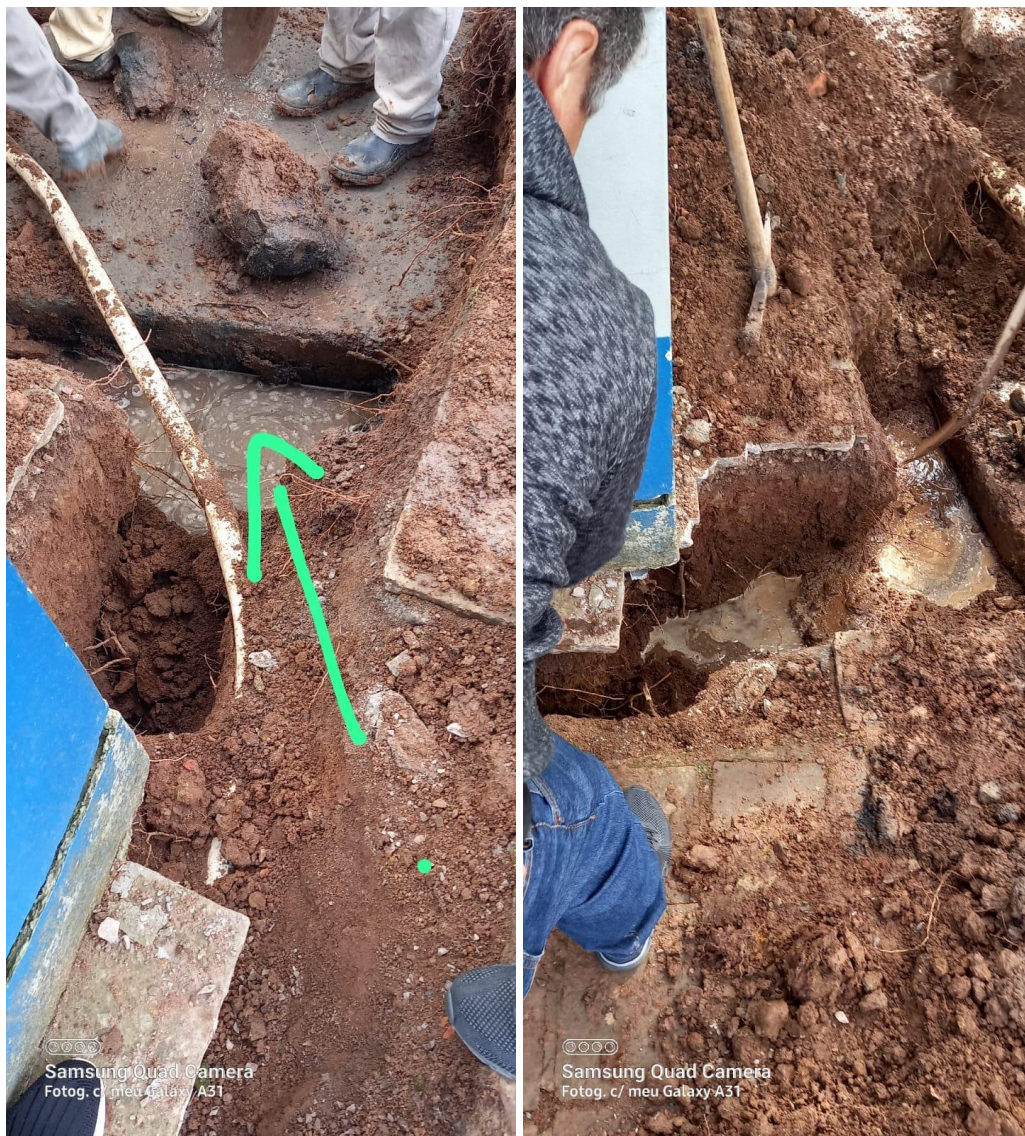
Vazamento de esgoto, sendo identificado se tratar de um sumidouro.
