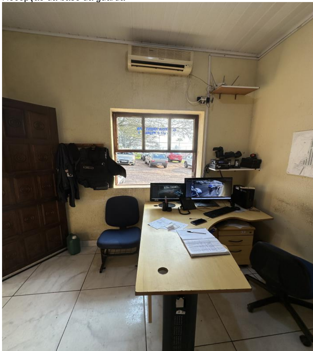
Foto 07 : No local o piso não possui superfície antiderrapante causando deslizamentos; há vidro trincado; Não há grades nas janelas; paredes sujas com pontos de fissuras; Forro apresenta infiltrações;
