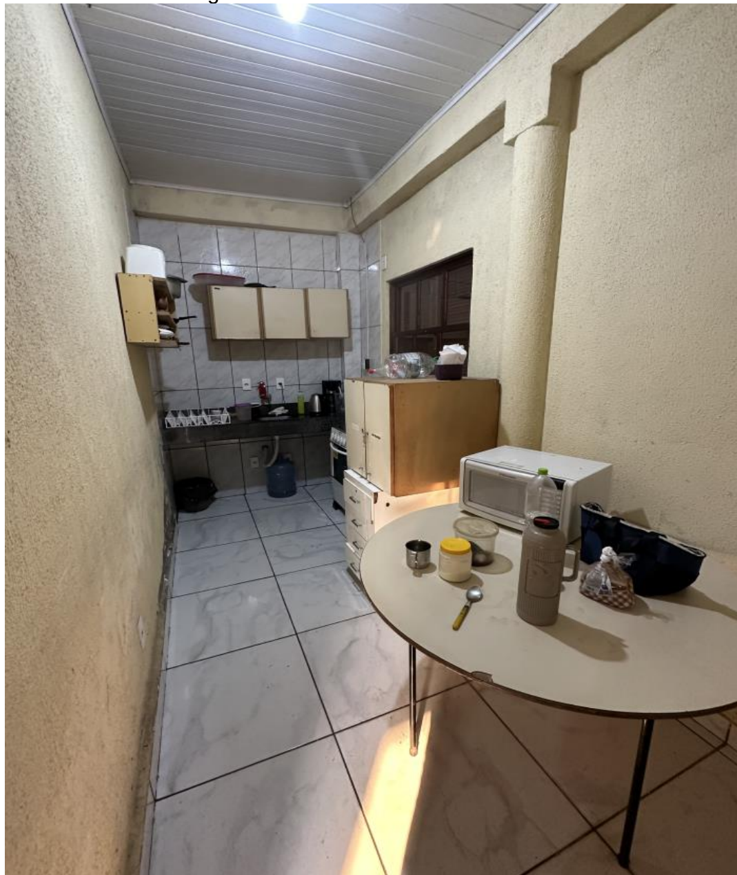
Foto 12 : Cozinha com infiltrações mostra forno danificado; presença de botijão de gás de cozinha dentro do recinto;
