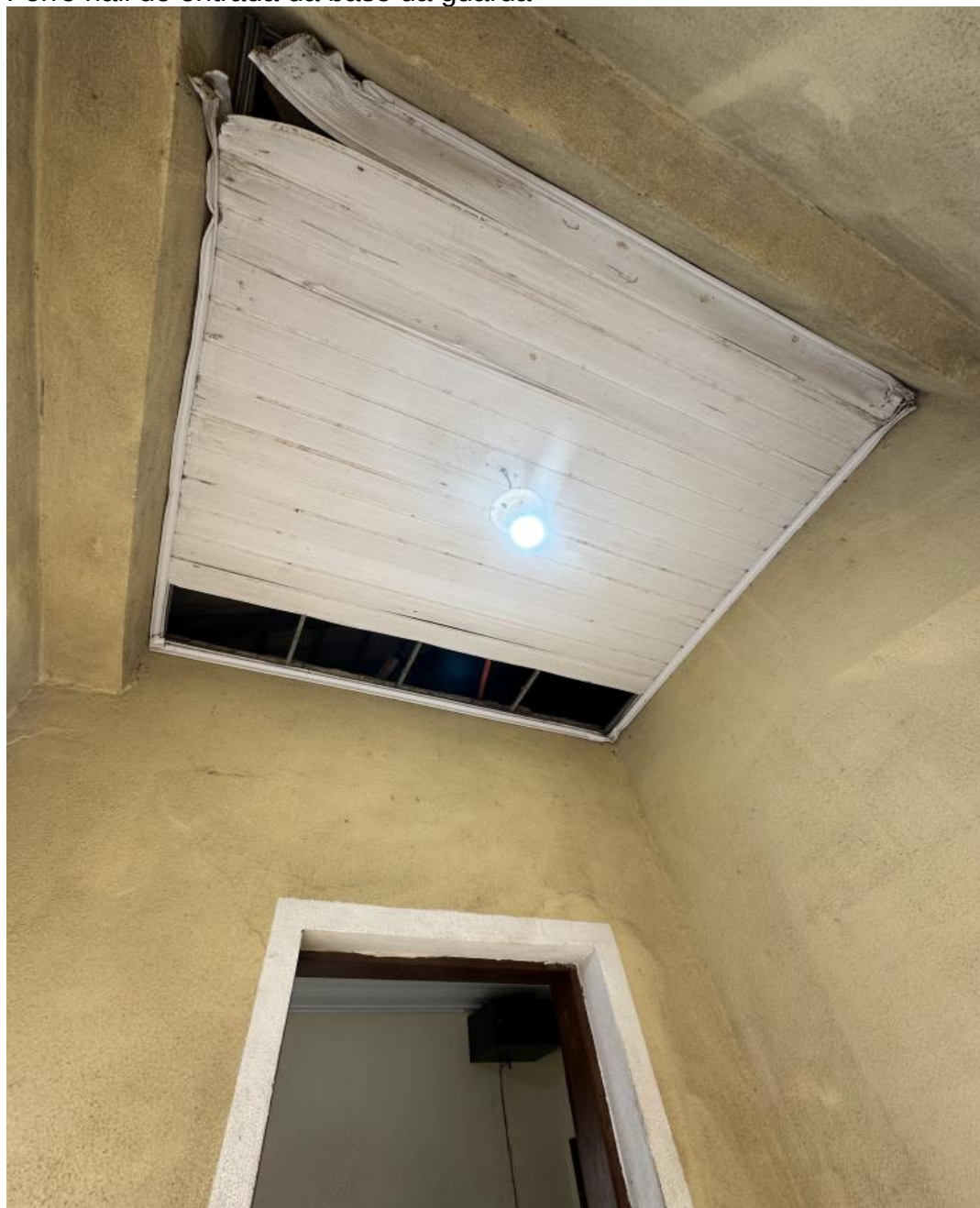
Foto 06 : Forro existente totalmente danificado;
