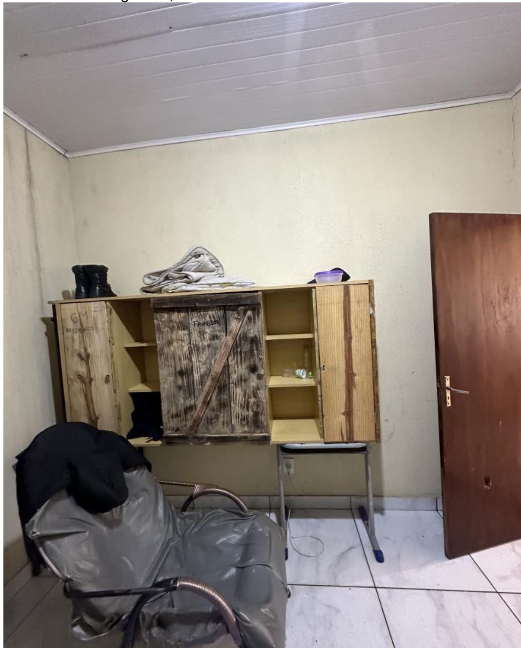
Foto 09 : Sala com infiltrações mostra forro danificado; folha de porta e fechadura danificadas;
