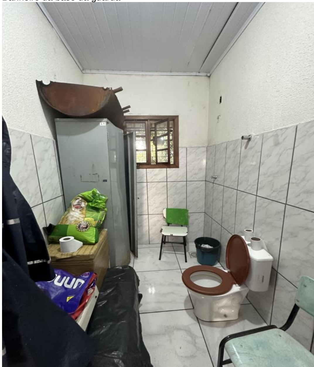
Foto 10 : Banheiro com infiltrações, mostra forro danificado; folha de porta e fechadura danificadas; Não há porta de box e chuveiro para a reativação de uso de banhos; vaso sanitário está solto do piso;
