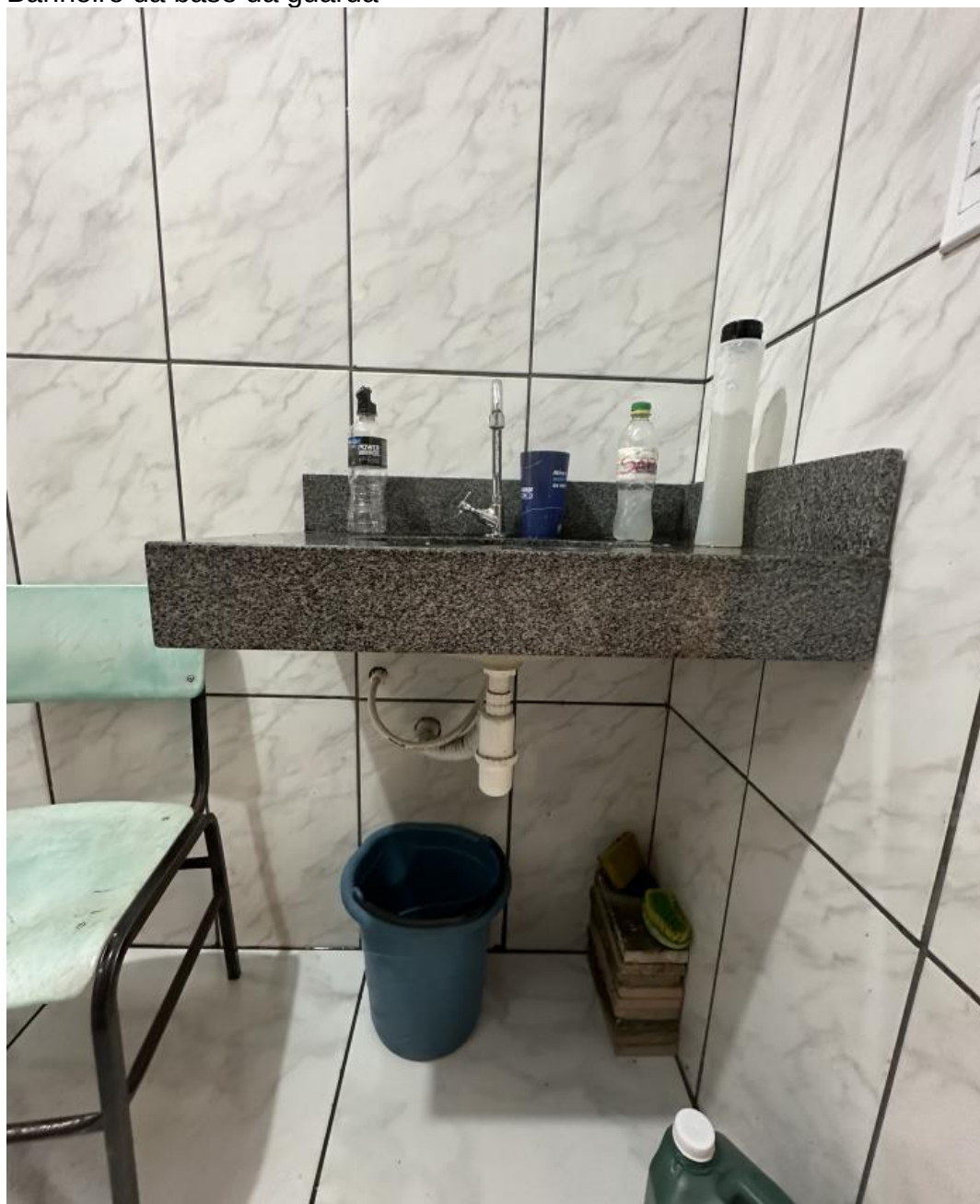
Foto 11 : Bancada do banheiro necessita de filete de granito em sua borda para conter respingos de água que se acumulam e se encaminham para o piso;
