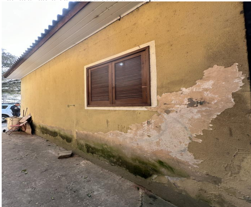
Foto 02 : Mostra revestimento e pintura das paredes danificados;
