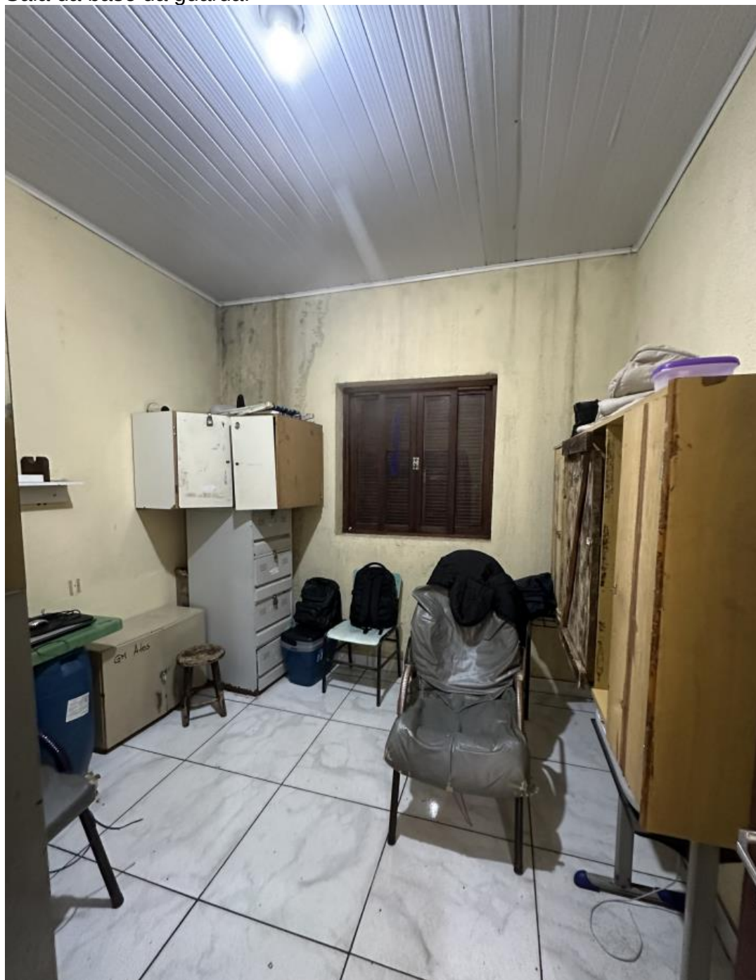
Foto 08 : Sala com infiltrações pelo forro e paredes.
