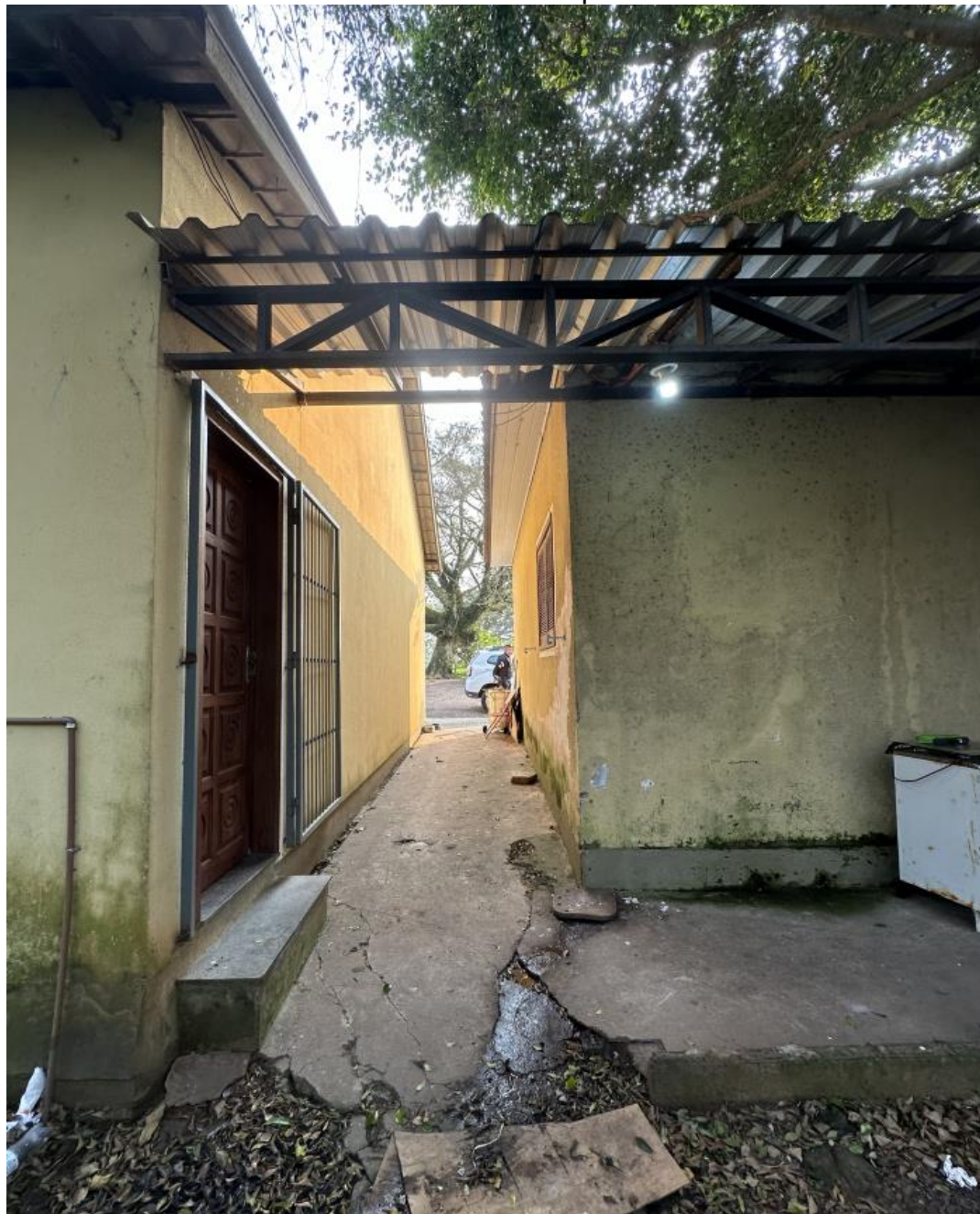
Foto 03 : Mostra danos no piso cimentado devido ao vazamento da caixa de gordura;
