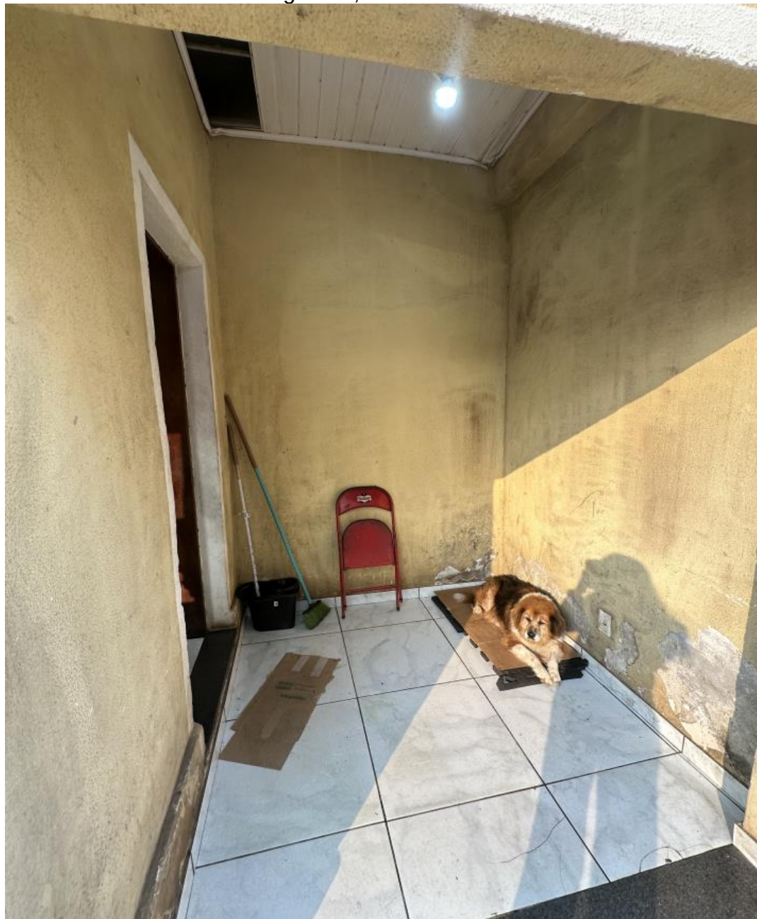
Foto 05 : Mostra piso existente não possui superfície antiderrapante causando deslizamento; revestimento de reboco de parede danificado;
