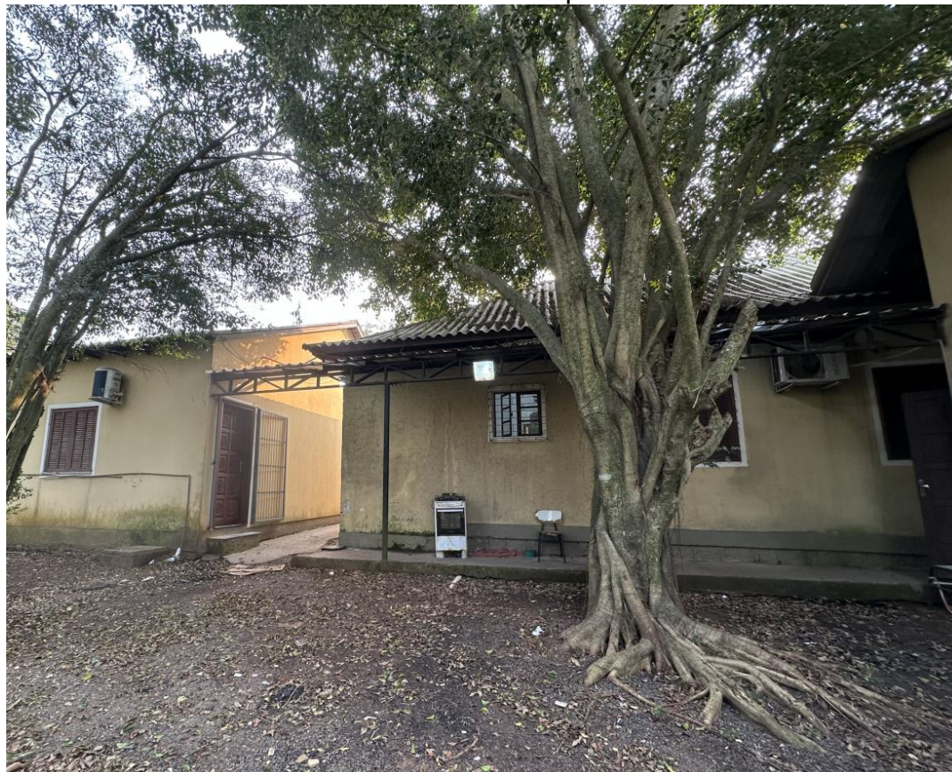
Foto 04 : Árvore junto ao prédio está danificando as telhas;
