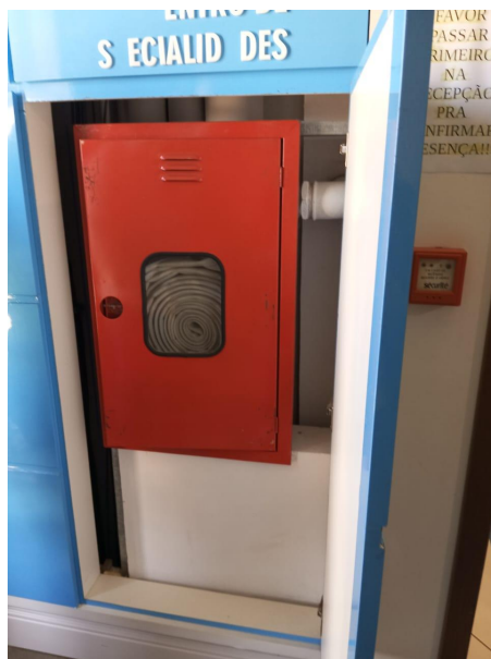
Foto 05 - Abrigo/Caixa de Hidrante
