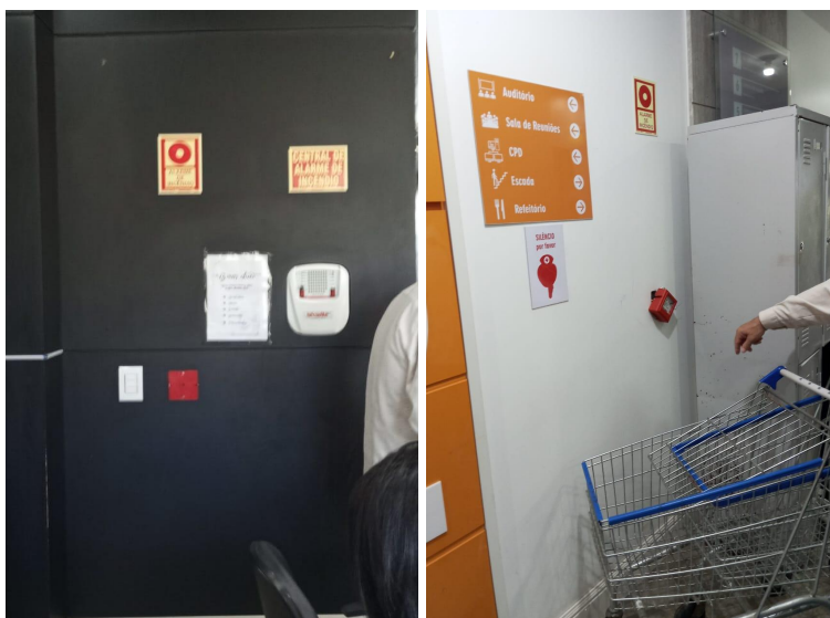
Fotos 03 e 04 - Botoeiras danificadas (térreo e 2º pavimento)
