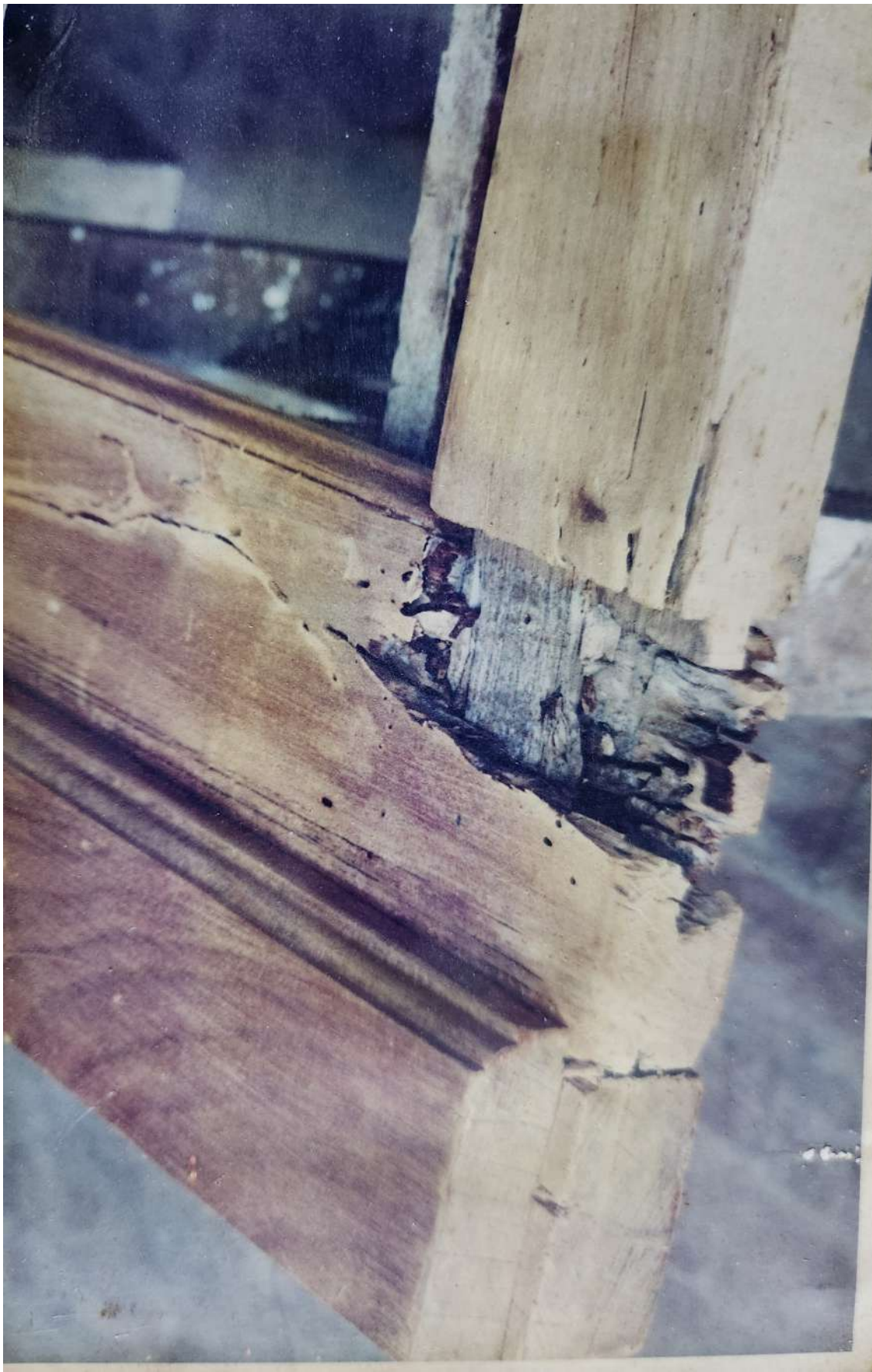
Detalhe da madeira danificada
