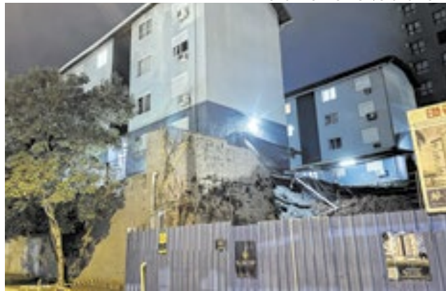
Deslizamento atingiu parte do condomínio
