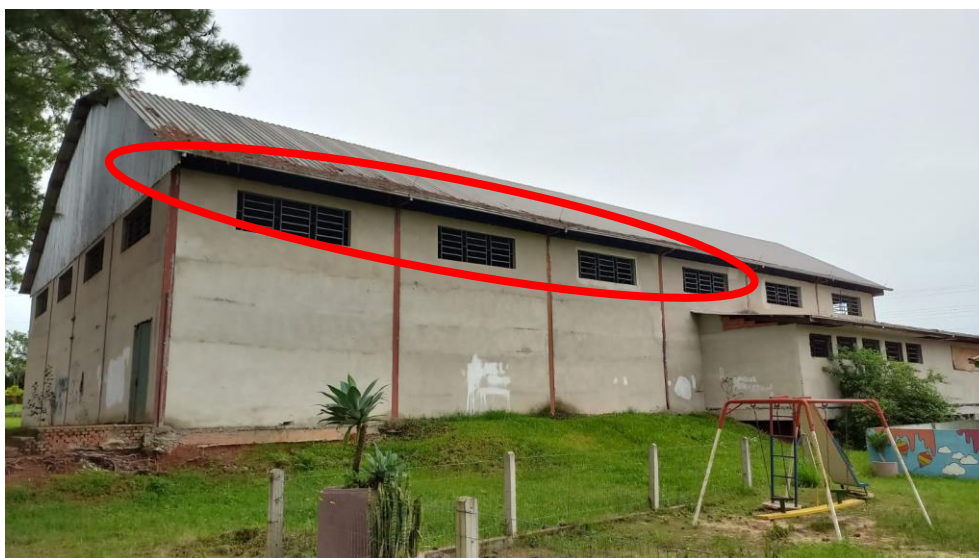
Imagem 09 – Calhas do ginásio entupidas
