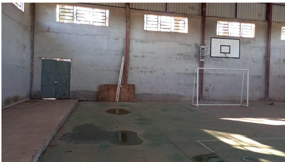
Imagem 14 – Goteiras do telhado/cobertura
