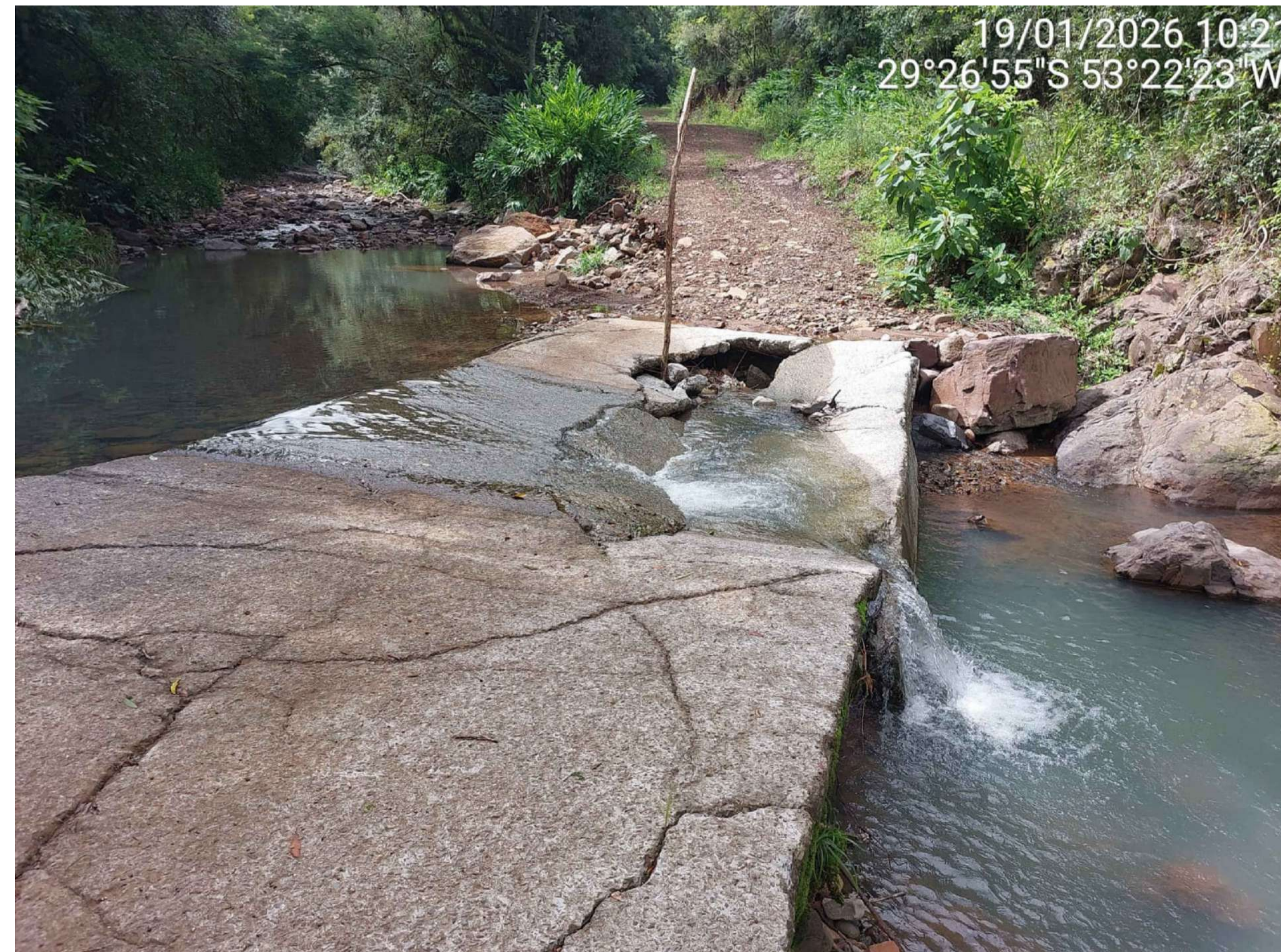
Imagem do local Passagem Molhada com estrutura comprometida conforme Laudo Técnico
