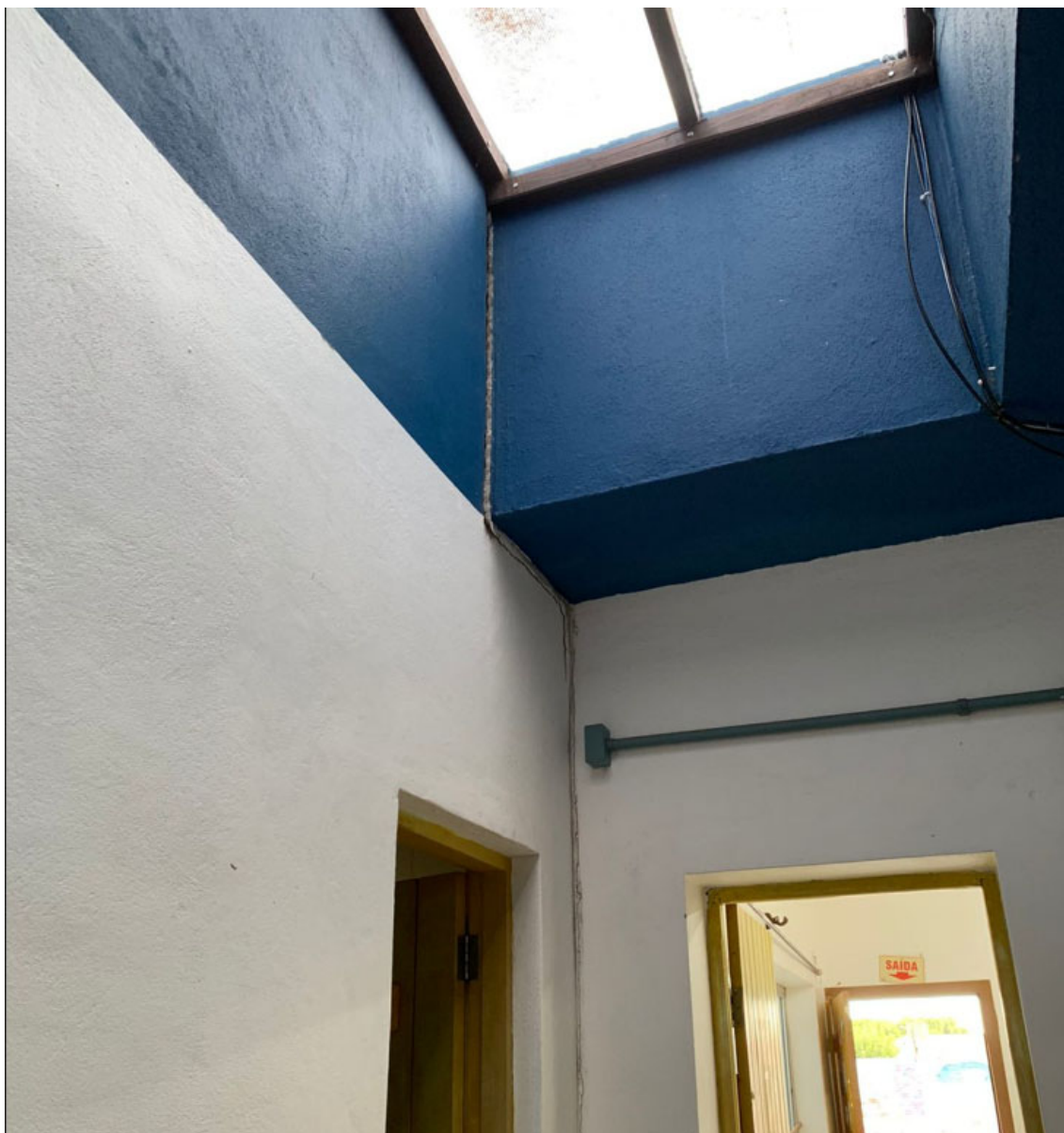
Imagem 3 - Trinca no encontro das paredes
