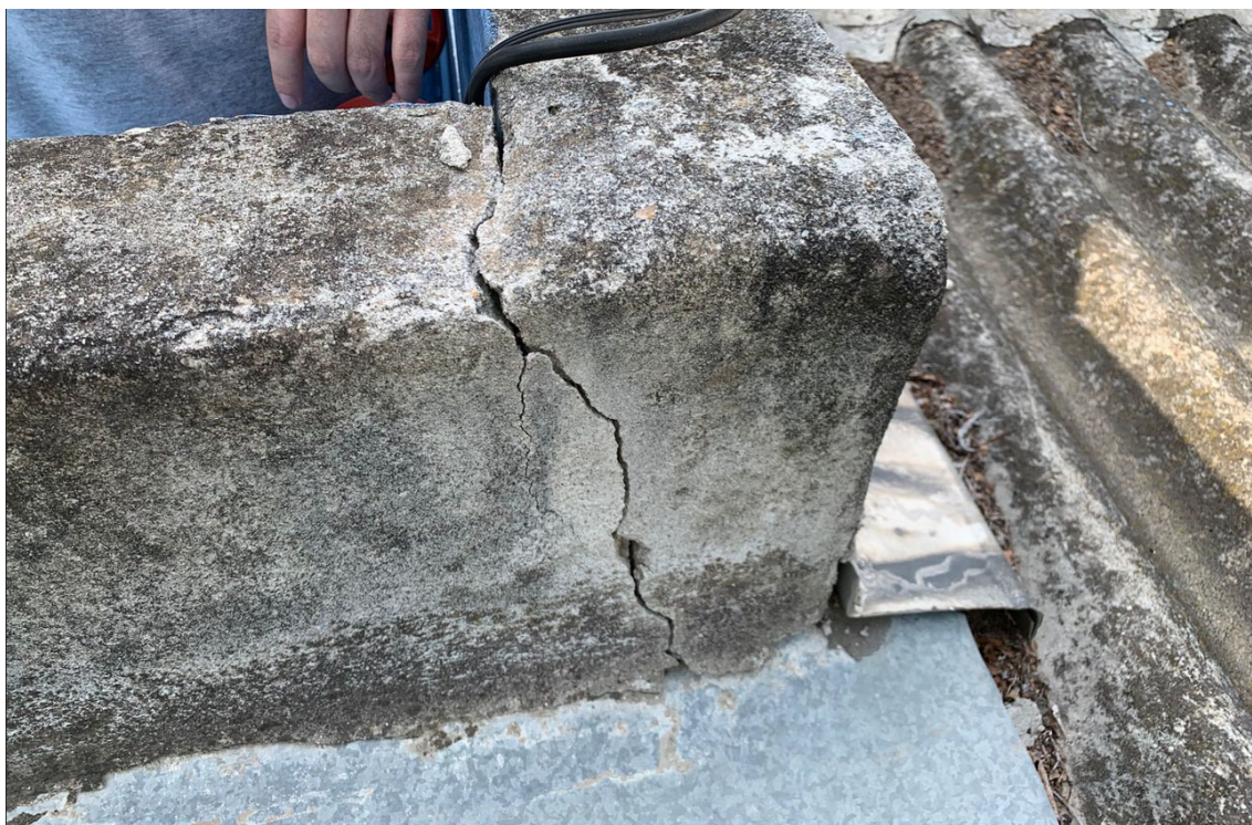
Imagem 3 - Trinca na alvenaria da claraboia
