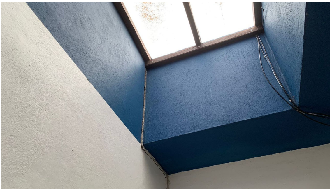
Imagem 2 - Trinca na alvenaria da claraboia
