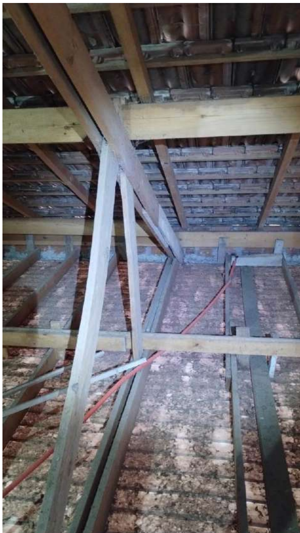
Foto 9 – Emenda realizadas com madeira de má qualidade e curvatura da estrutura de forro e dos caibros e ripas apresentando o vestígio de movimentação estrutural.
