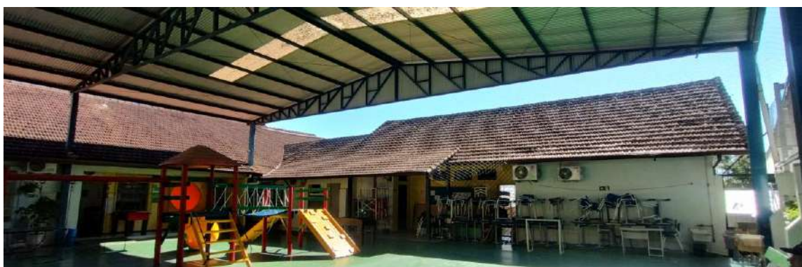
Foto 15 – À direita dessa foto, temos a vista do telhado referente às fotos que seguem onde a maior ação de deterioração foi realizada por ataque de cupins.
