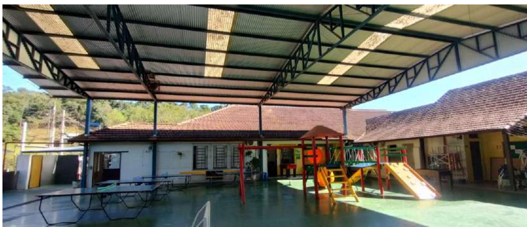
Foto 4 – À esquerda da foto, vista do telhado com problemas estruturais graves.
