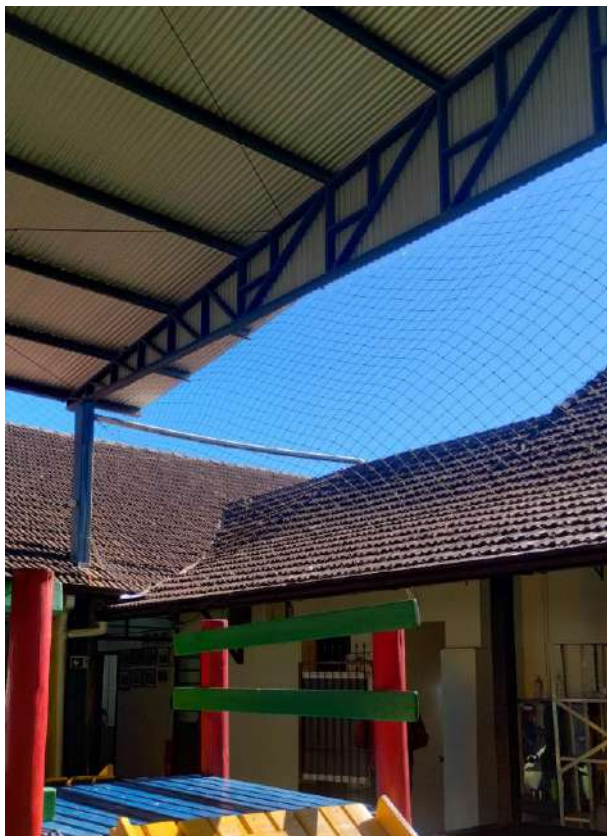
Foto 14 – Foto externa na união entre parte mais antiga e mais nova da construção onde podemos verificar a irregularidade nas águas do telhado causados pela movimentação estrutural.
