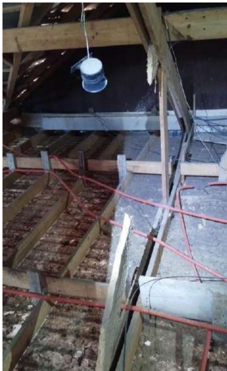
Foto 12 – Nessa foto, além da peça empenada por esforço inadequado na estrutura, podemos identificar as instalações elétricas executadas de forma completamente inadequadas.
