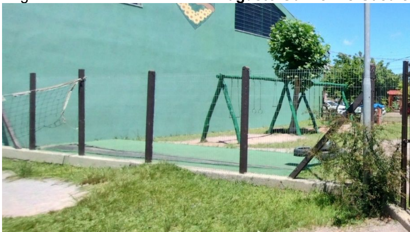
Foto 5 – Local onde existe a pavimentação de grama sintética e está soltando completamente causando muitos acidentes com as crianças.
