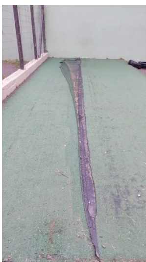
Foto 6 – Pavimento em grama sintética extremamente desgastado e soltando.
