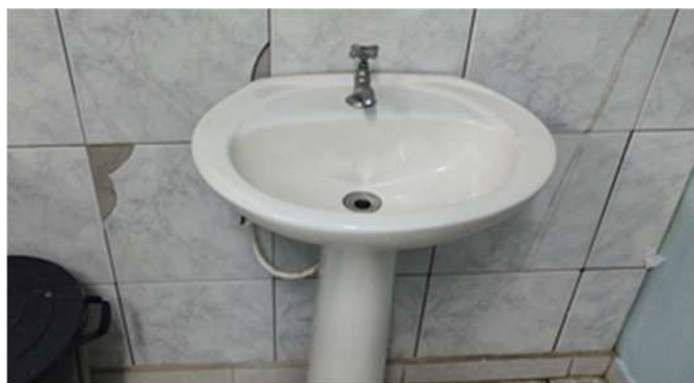
Foto 3 – Lavatório solto, necessitando fixação e parte da parede que precisa ter as falhas reparadas e frestas a serem fechadas.
