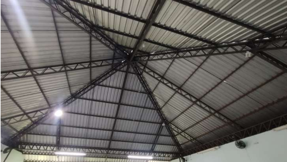
Foto 2 – Telhado com vazamentos
