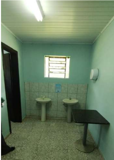
Foto 12 – Parede dos lavatórios com muitas fendas
