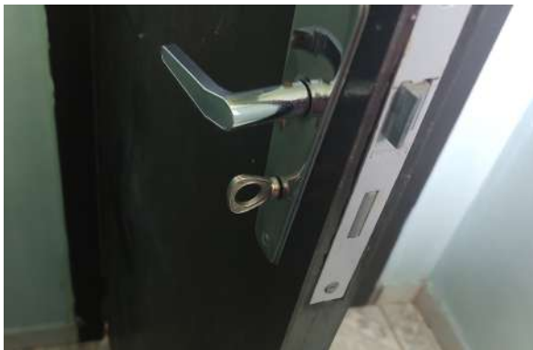
Foto 13 – Fechadura das cabines dos banheiros devem ter o sistema de fechamento substituído para um mais seguro para as crianças.
