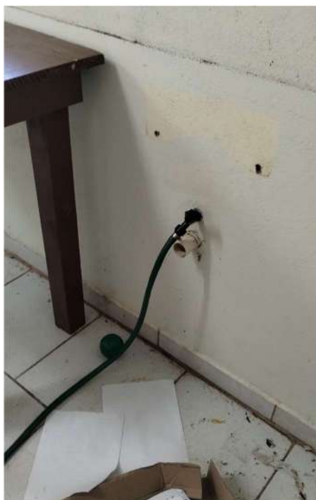
Foto 2 – Exemplo de instalação de água e esgoto que necessita de correto fechamento.
