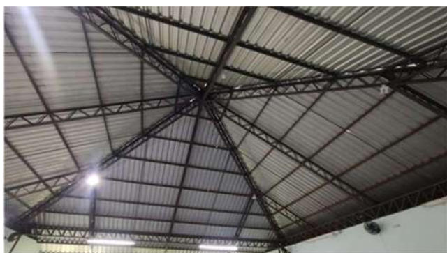
Foto 1 – Furos e frestas no telhado
