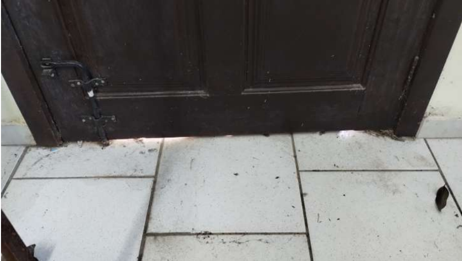
Foto 5 – Instalação de rodo pelo lado externo da porta para impedimento da entrada de água das chuvas e animais rasteiros
