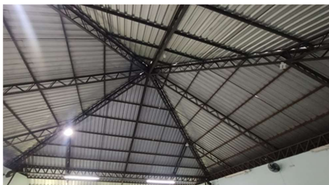
Foto 1 – Furos e frestas no telhado
