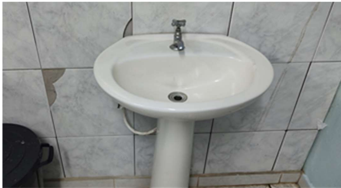
Foto 3 – Lavatório solto, necessitando fixação e parte da parede que precisa ter as falhas reparadas e frestas a serem fechadas.
