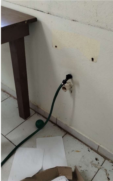
Foto 2 – Exemplo de instalação de água e esgoto que necessita de correto fechamento.
