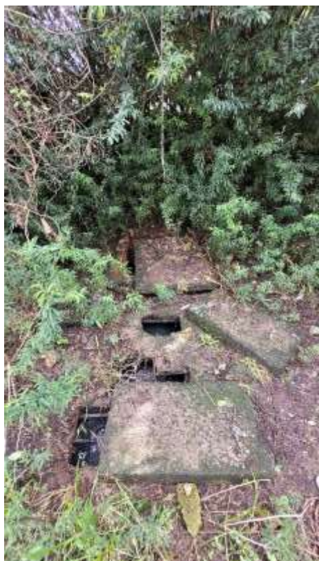
Figura 3 – Pontos sobre o piso com buracos
