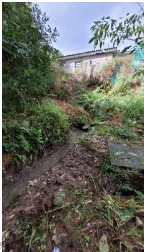
Figura 5 – Caminho formado pelos esgotos devido a obstrução da caixa de recepção dos esgotos
