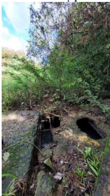
Figura 4 – Pontos sobre o piso com buracos e ferragens aparentes
