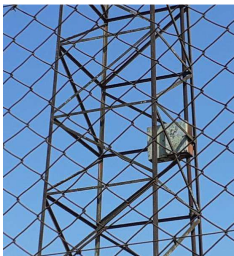
Fotografia 5 – Elemento de elétrica deteriorado
